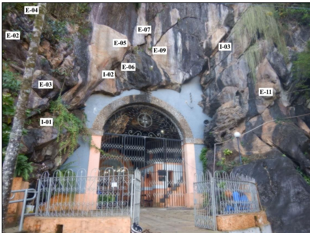
Figura 36 - Feições de instabilidade mapeadas na fachada, no pórtico e no entorno da entrada da Lapa de Antônio Pereira.
