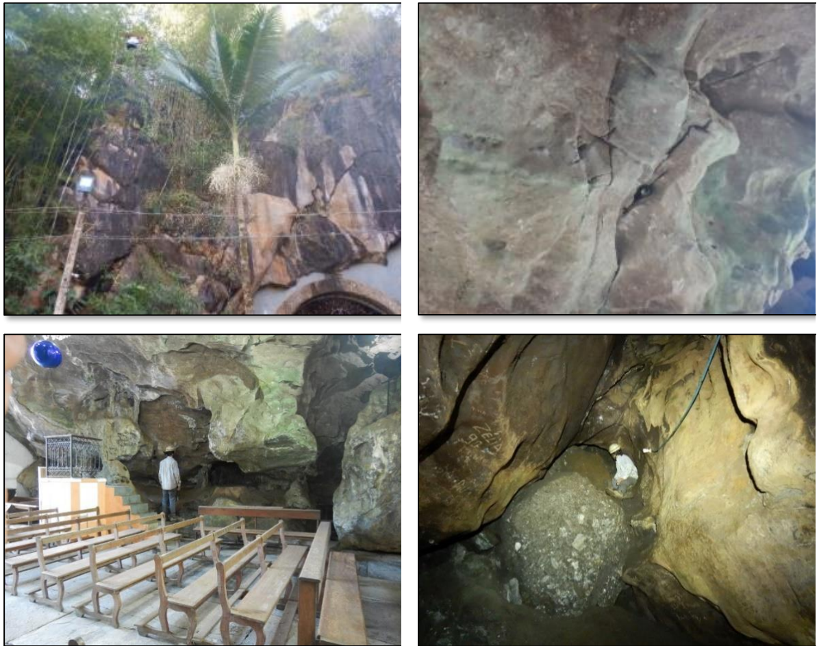
Figura 33 - Exemplos de feições de instabilidade reconhecidas nos domínios externo e interno da Lapa de Antônio Pereira em (A) torre residual, referente ao ponto E-02; em (B) bloco com possibilidade de tombamento, referente ao ponto I-11; em (C) pendente em balanço, referente ao ponto I-05; em (D) bloco com possibilidade de rolamento, referente ao ponto I-35.
