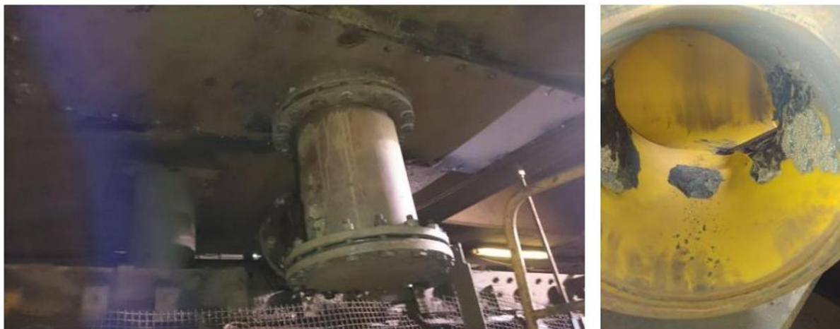
Figura 13 – Cachimbo revestido em PU e desgaste do revestimento Fonte: Documento case do sucesso
