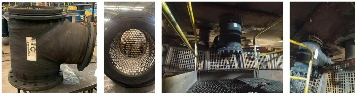
Figura 15 - Cachimbo revestido em borracha + cerâmica e desgaste do revestimento Fonte: Documento case do sucesso
