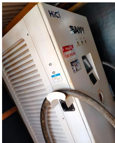
Figura 10 – Carregador convencional para caminhões elétricos Fonte: Elaboração própria
