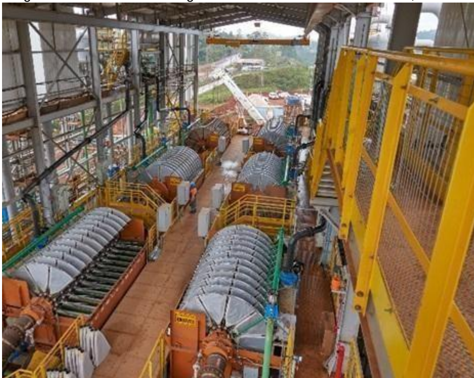
Figura 3. 5 - Planta de filtragem de filtros a vácuo na Samarco, Mariana
