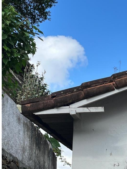
Figura 5 – Vegetação invasiva e obstrução da calha e do beiral da cobertura
