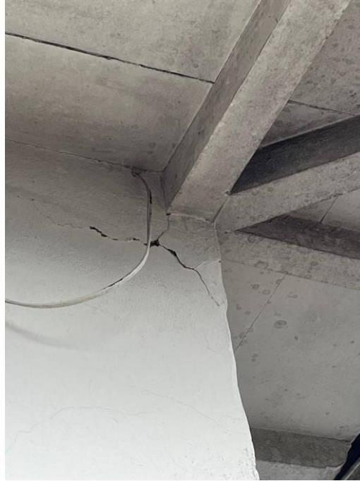
Figura 4 – Esmagamento da alvenaria de vedação por sobrecarga do telhado no apoio da cobertura
