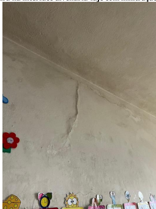
Figura 9 – Fissura na interface alvenaria-laje com infiltração em sala de aula
