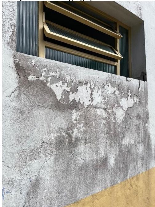
Figura 7 – Destacamento da pintura e desagregação do revestimento sob o peitoril da janela
