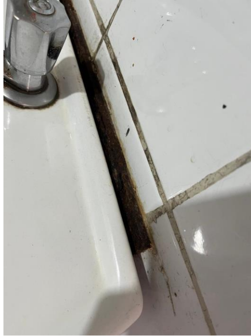
Figura 13 – Corrosão uniforme do suporte metálico de pia em banheiro
