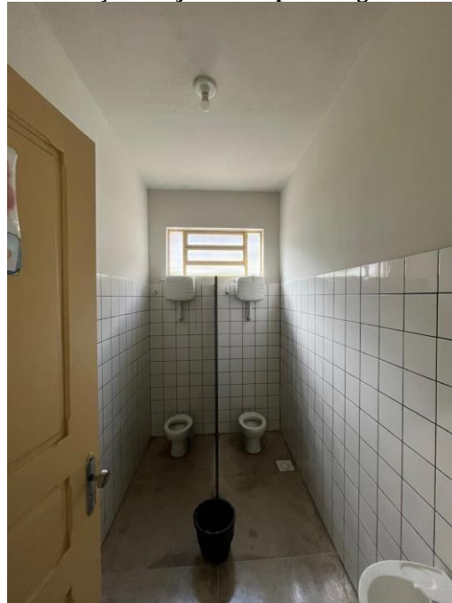
Figura 12 – Deterioração das juntas do piso em granitina em banheiro
