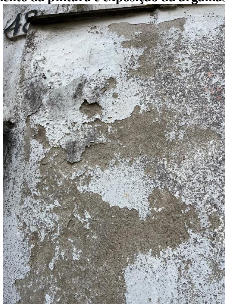
Figura 6 – Descascamento da pintura e exposição da argamassa no muro de fachada
