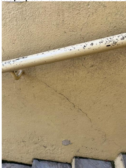
Figura 14 – Corrosão por pites e fissura no chumbamento do corrimão da escada
