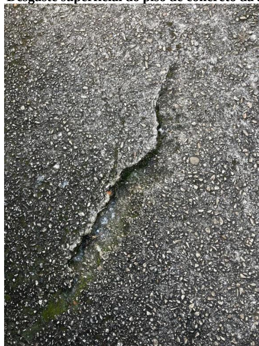
Figura 11 – Desgaste superficial do piso de concreto da área externa
