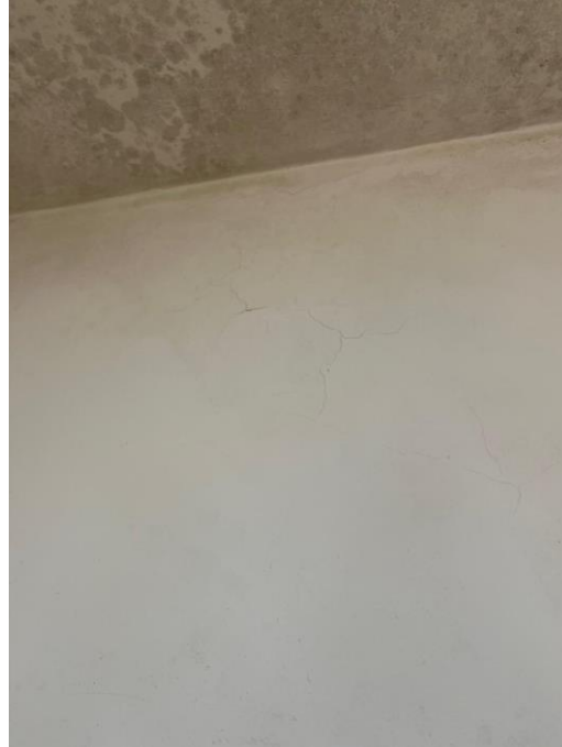
Figura 10 – Fissuras mapeadas e colonização fúngica na argamassa de parede/teto
