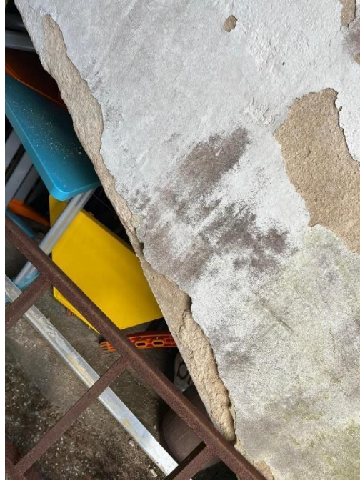
Figura 8 – Descolamento em placas do revestimento argamassado em parede externa
