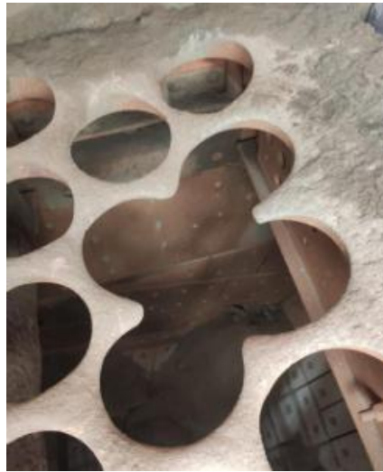
Figura 20: Módulo de grelha danificado
