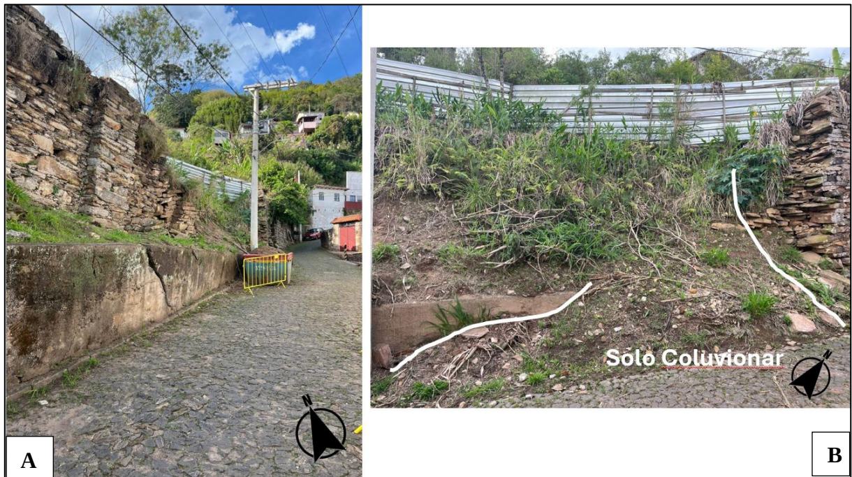
Figura 6.17 - Muro implantado na base da encosta, apresentando sinais de deformação (A). Em (B), solo coluvionar, com acúmulo de material inconsolidado e raízes expostas, associado ao movimento lento do tipo rastejo.
