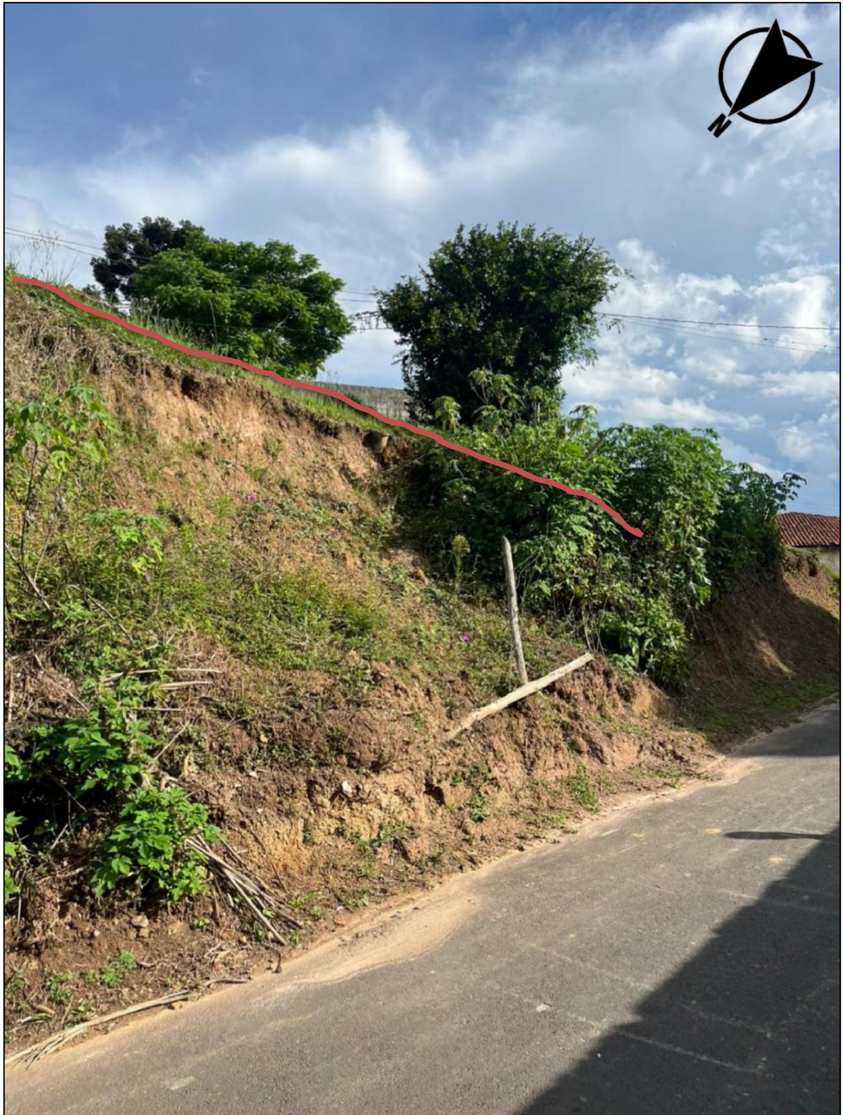
Figura 6.9 – Ponto P1, cicatriz de escorregamento planar em talude de corte. A linha vermelha representa a crista do escorregamento.
