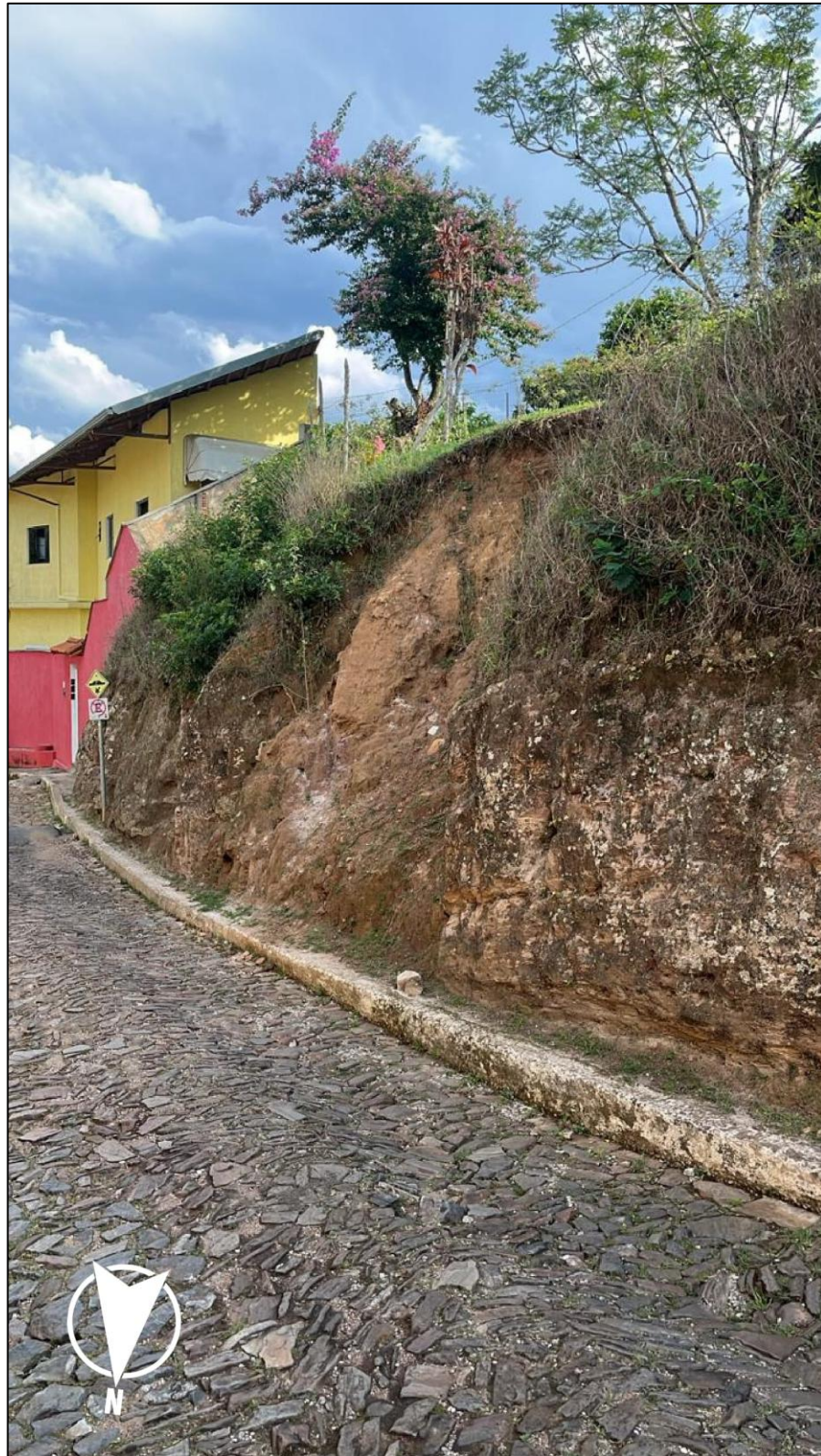
Figura 9.3 – Vista geral do talude de corte no P2, localizado na Rua Rio de Janeiro, com exposição de filitos alterados da Formação Cercadinho e intercalações quartzíticas localmente mais resistentes.
