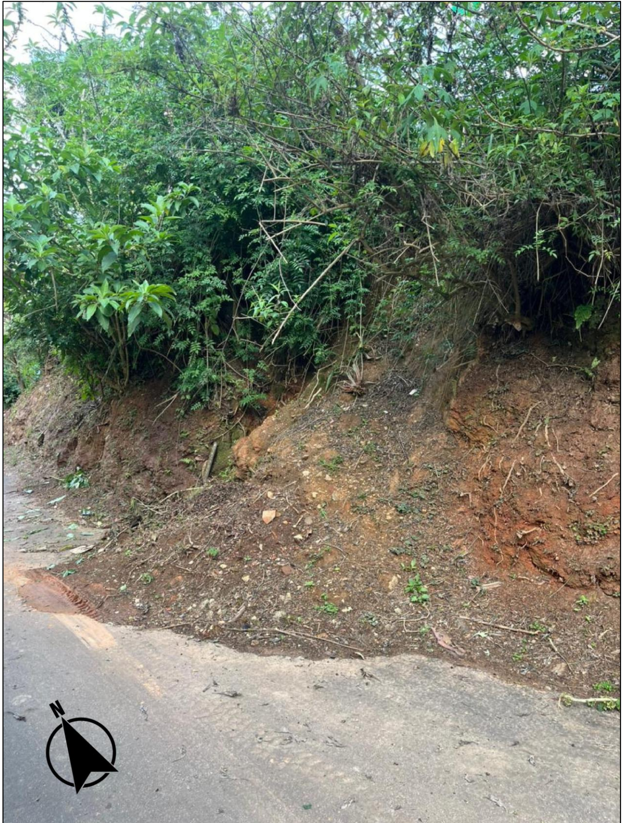
Figura 9.1 – Talude de corte no P1, localizado na Rua Rio Doce, evidências de produto de erosão linear.
