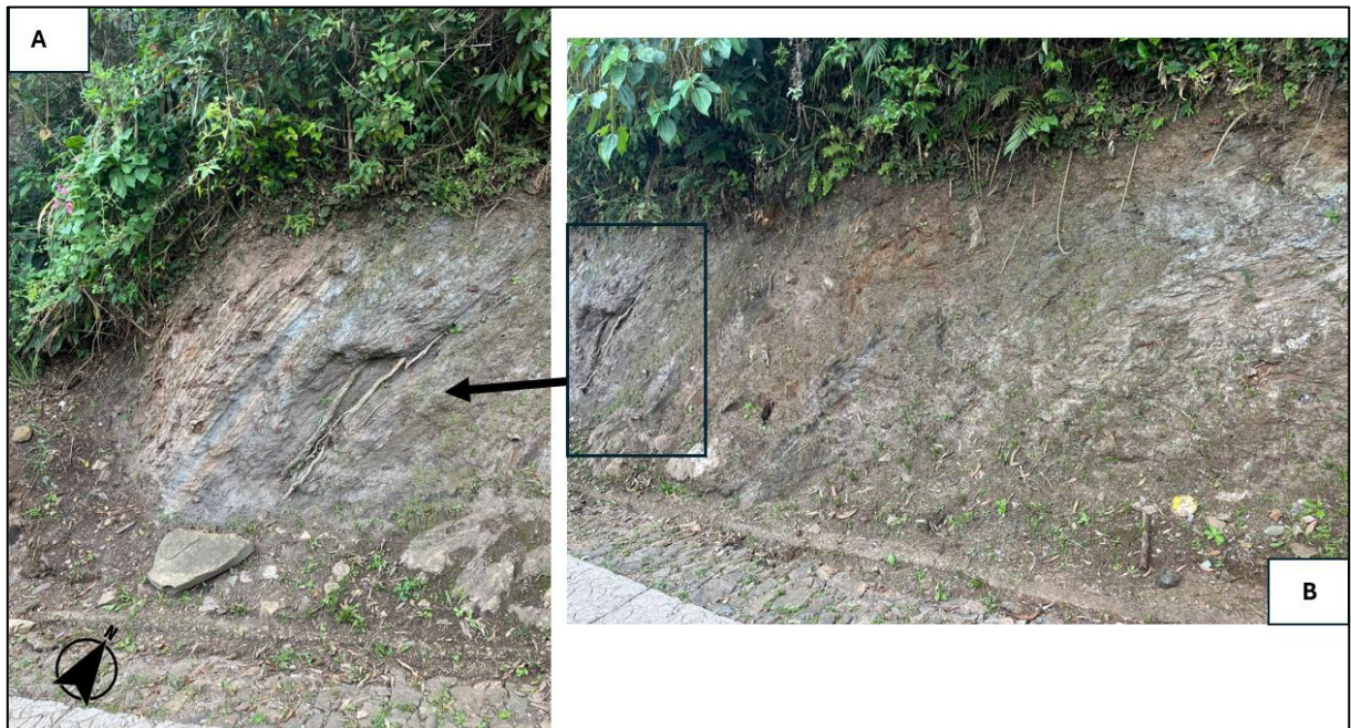
Figura 6.16- Talude de corte ao longo da Rua Valentim Policarpo, no P8, localizado na área de contato geológico entre as formações Cauê e Cercadinho. Em (A), observa-se uma porção do afloramento com bandamento preservado; em (B), o material apresenta maior grau de alteração, dificultando a identificação dessa estrutura. Também são observados sulco erosivo superficial e raízes expostas.
