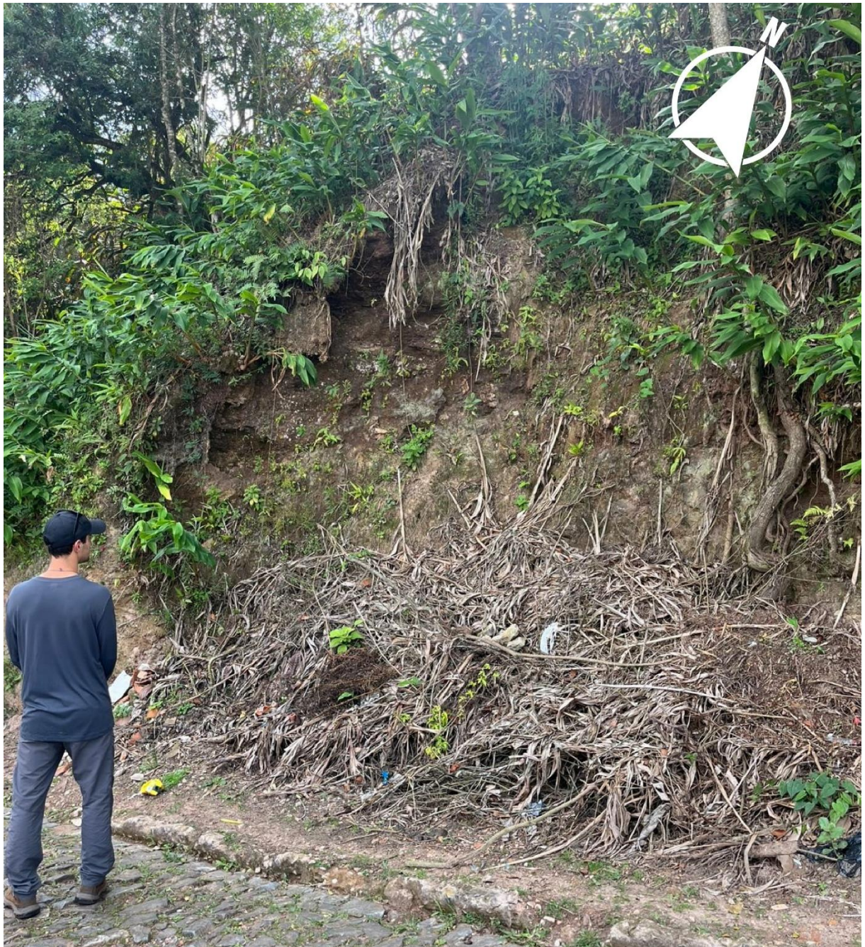
Figura 9.5 - Talude no P3, localizado na Ladeira João de Paiva, constituído por solo residual saprolítico derivado de filitos da Formação Cercadinho. Observam-se raízes expostas, erosão superficial e acúmulo de material orgânico misturado a solo fino na base.
