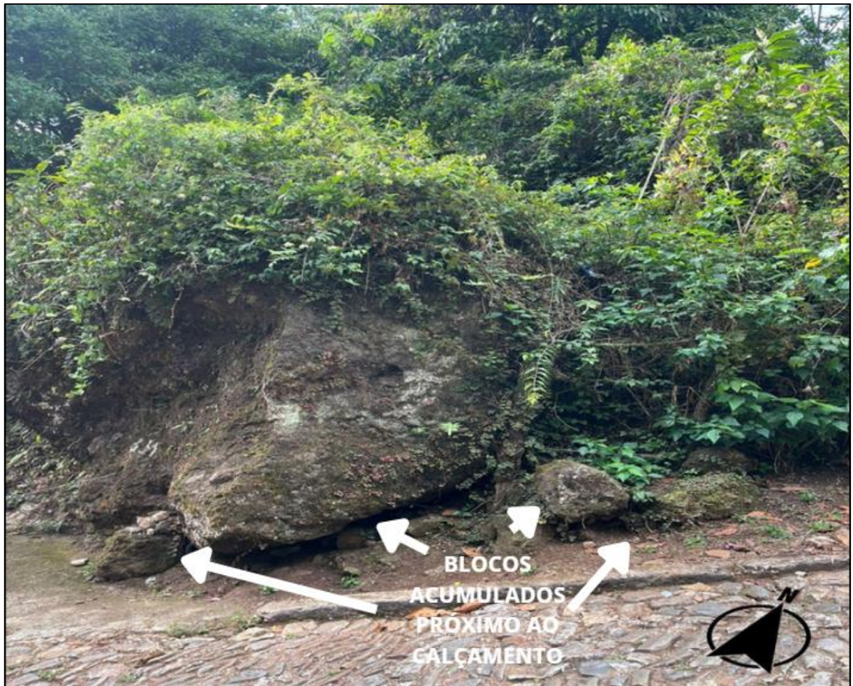
Figura 9.6 - Talude no P4, localizado na Ladeira João de Paiva, com exposição de itabirito da Formação Cauê e presença de blocos, matacões e fragmentos próximos à via, compatíveis com desprendimentos localizados e posterior rolamento.
