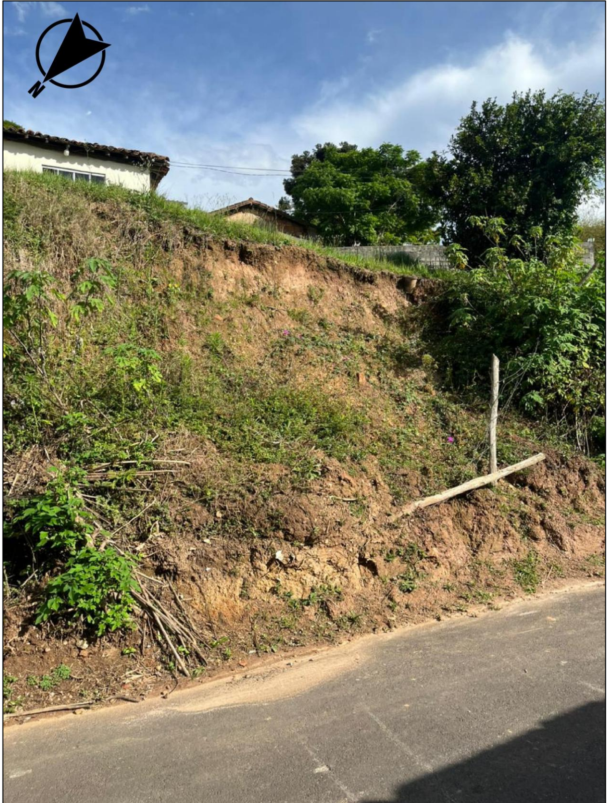
Figura 9.2 – Vista geral da cicatriz de escorregamento planar observada no P1, em talude de corte na Rua Rio Doce.
