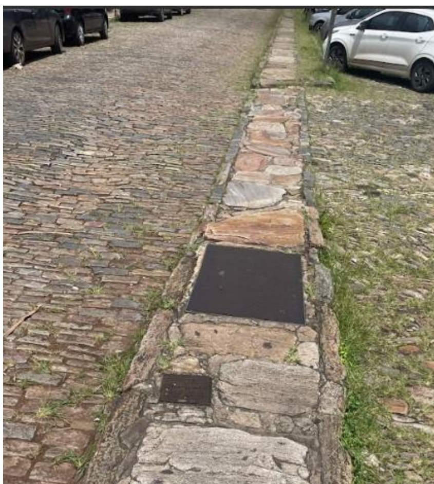
Figura 1: Elemento de infraestrutura urbana (tampa de inspeção) inserido de forma irregular na calçada em via do centro histórico de Ouro Preto/MG, comprometendo a segurança e a acessibilidade do deslocamento pedonal.
