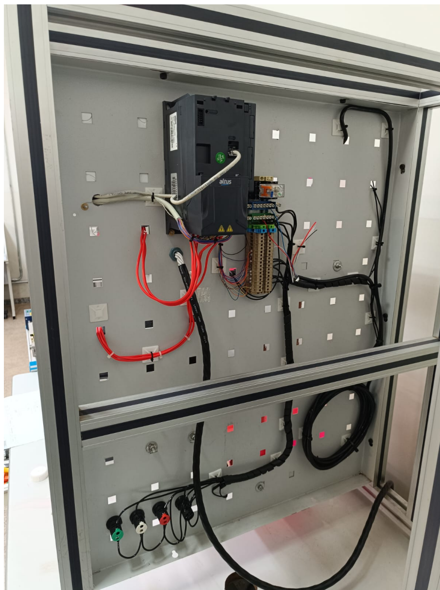
Figura 19 – Vista traseira do Kit com o inversor de frequência e o barramento de bornes. Fonte: Acervo do autor (2026).
