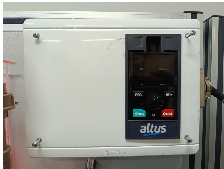
Figura 18 – Novo quadro de acionamento com a IHM do inversor. Fonte: Acervo do autor (2026).
