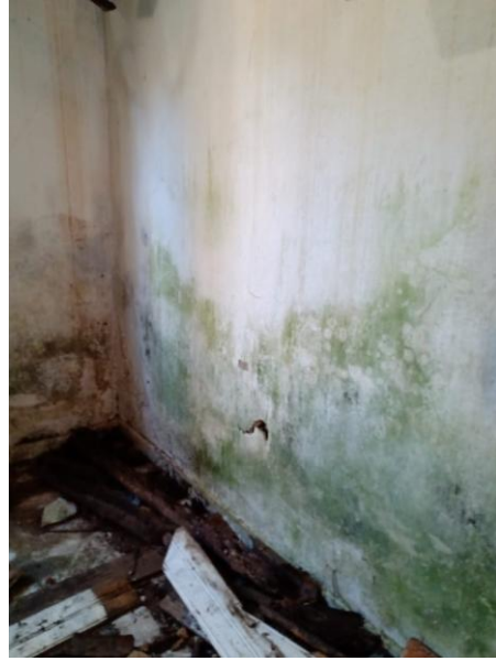
Figura 13 – Infiltração em parede interna da Casa 01.
