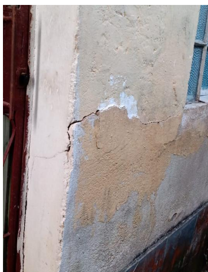
Figura 18 – Trinca na fachada da Casa 02.
