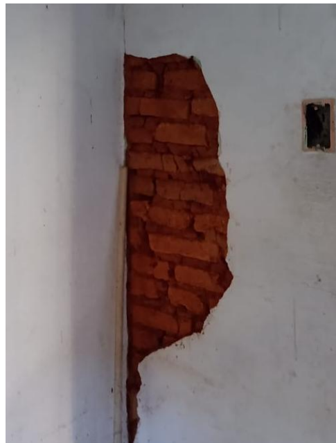
Figura 17 – Desplacamento de reboco em parede interna da Casa 01.
