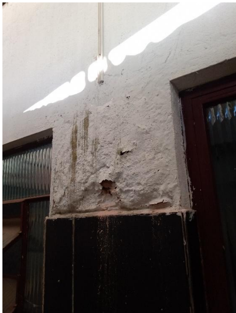
Figura 16 – Desplacamento de reboco em parede interna da Casa 02.
