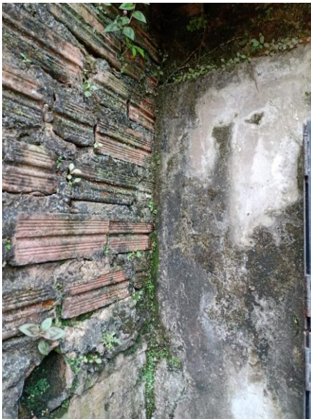
Figura 14 – Formação de bolor no muro externo das edificações.
