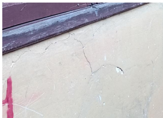
Figura 19 – Fissura na fachada da Casa 01.
