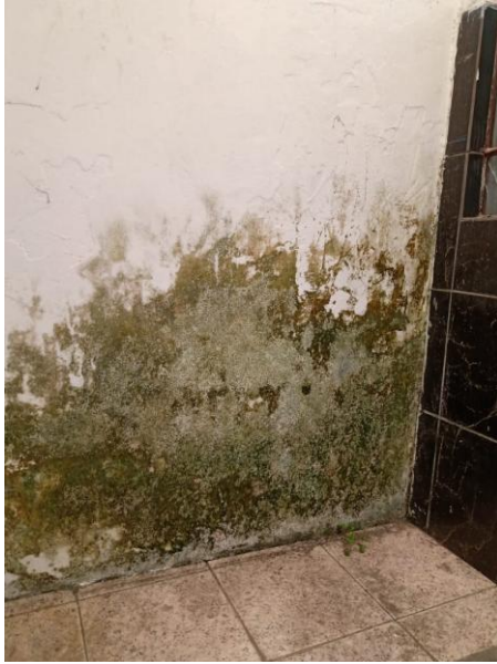
Figura 12 – Infiltração em parede interna da Casa 02.
