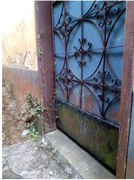
Figura 15 – Formação de bolor na porta de entrada da Casa 01.
