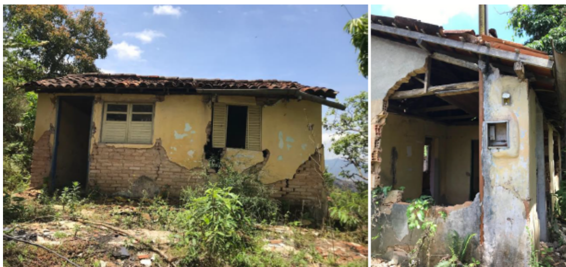
Imagens 1 e 2: Exemplos de casas que foram desocupadas devido ao Alto Risco nos bairros Taquaral e Piedade. Fonte: Fundação Gorceix (2024)
