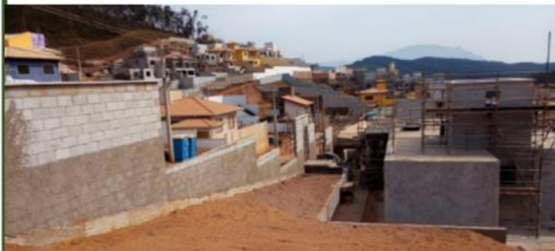
Figura 26: Registro das obras do reassentamento coletivo de Bento Rodrigues. Fonte: José Nascimento de Jesus, 2021.
