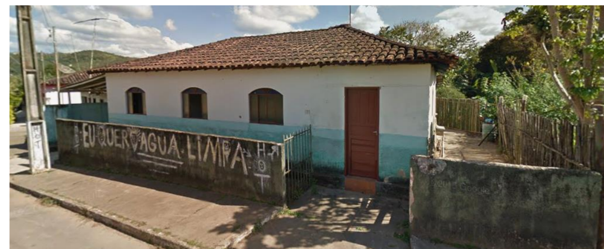
Figura 55: Edificação de Bento Rodrigues, destruída pelo rejeito tóxico em 2015. Fonte: Google Maps, acesso em 10 jan. 2026.
