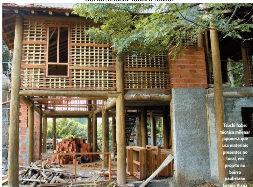
Figura 5 - Casa na Granja Viana erguida a partir da aplicação de uma técnica japonesa milenar denominada tsuchi kabe .
