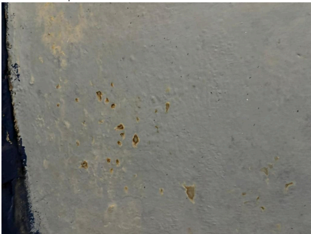
Figura 33: localizado na parede.
