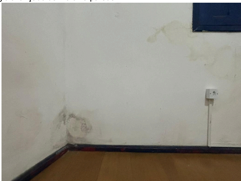
Figura 22: Estágio avançado de mofo na parede.
