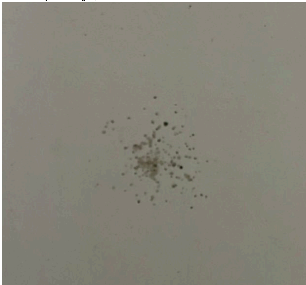
Figura 17: Proliferação de fungos, localizada no teto.
