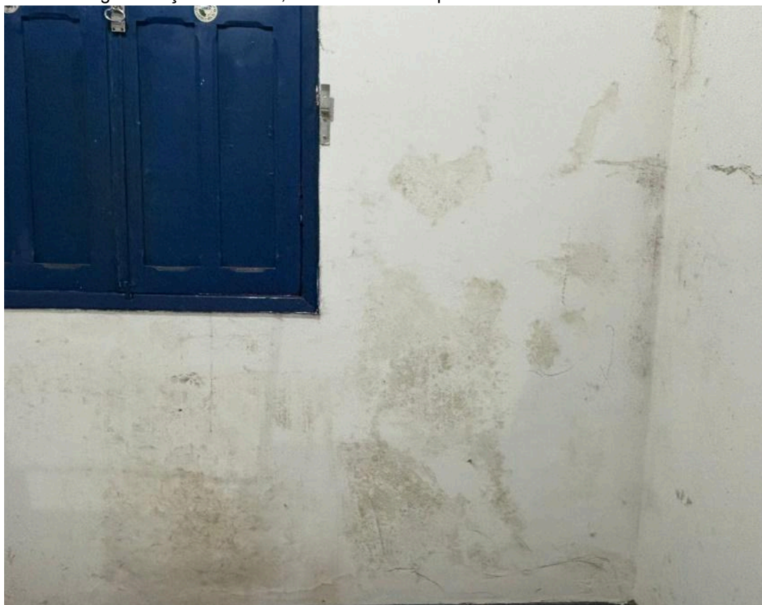
Figura 20: Estágio avançado de mofo, no lado direito da parede.
