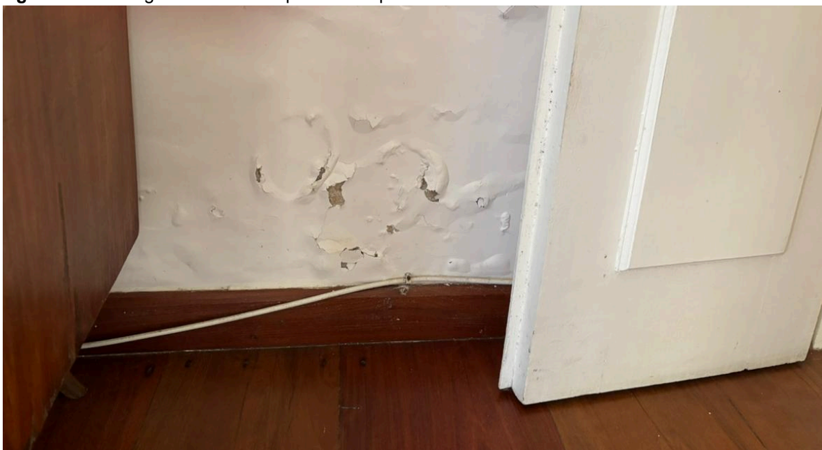
Figura 36: Patologia localizada na parede do quarto 2.
