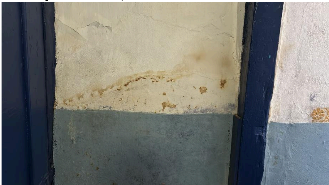
Figura 29: Patologias encontradas na parede do corredor no mês de Janeiro.
