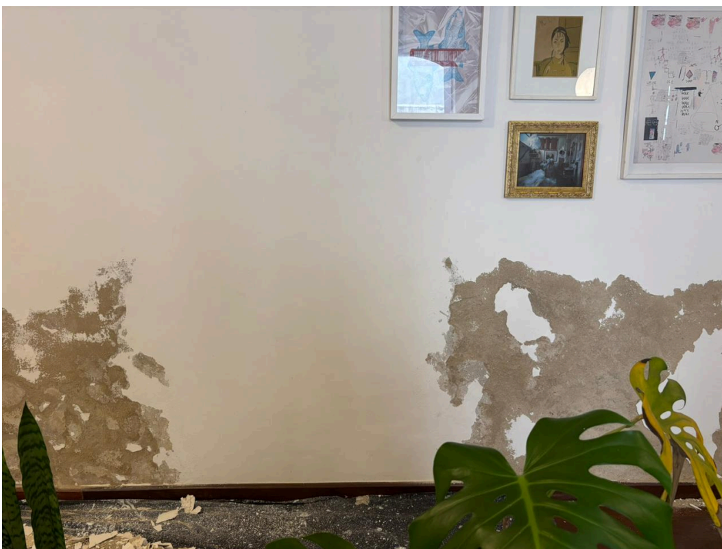
Figura 39: Parede da sala após descascamento do estufamento do revestimento.
