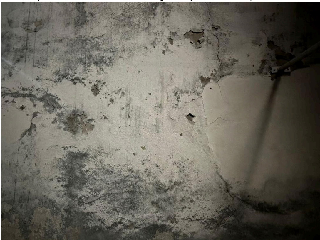
Figura 26: Desplacamento do revestimento e estágio avançado de mofo na parede externa.
