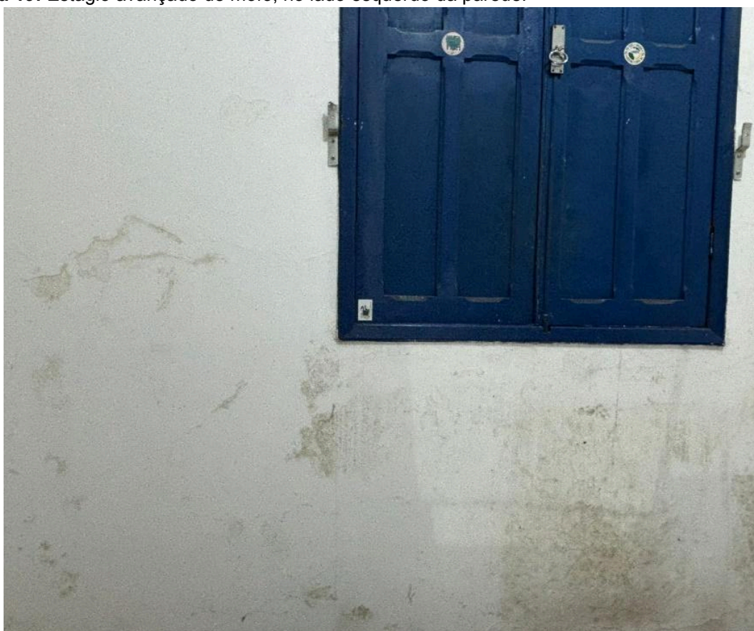
Figura 19: Estágio avançado de mofo, no lado esquerdo da parede.
