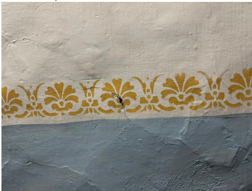
Figura 32: localizado na parede.
