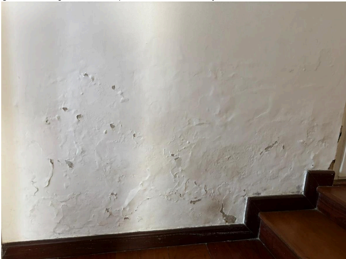
Figura 35: Patologia localizada na parede da Área de Circulação.
