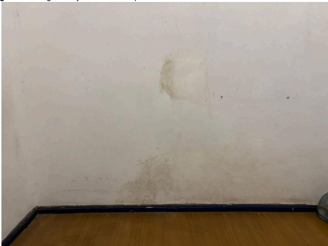
Figura 21: Estágio avançado de mofo na parede.
