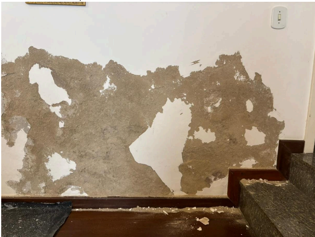
Figura 38: Parede da sala após descascamento do estufamento do revestimento.
