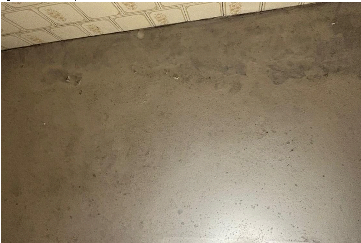
Figura 25: Manchas por mofo, localizadas no teto.
