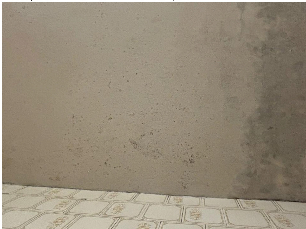
Figura 24: Desplacamento do revestimento e manchas por mofo.
