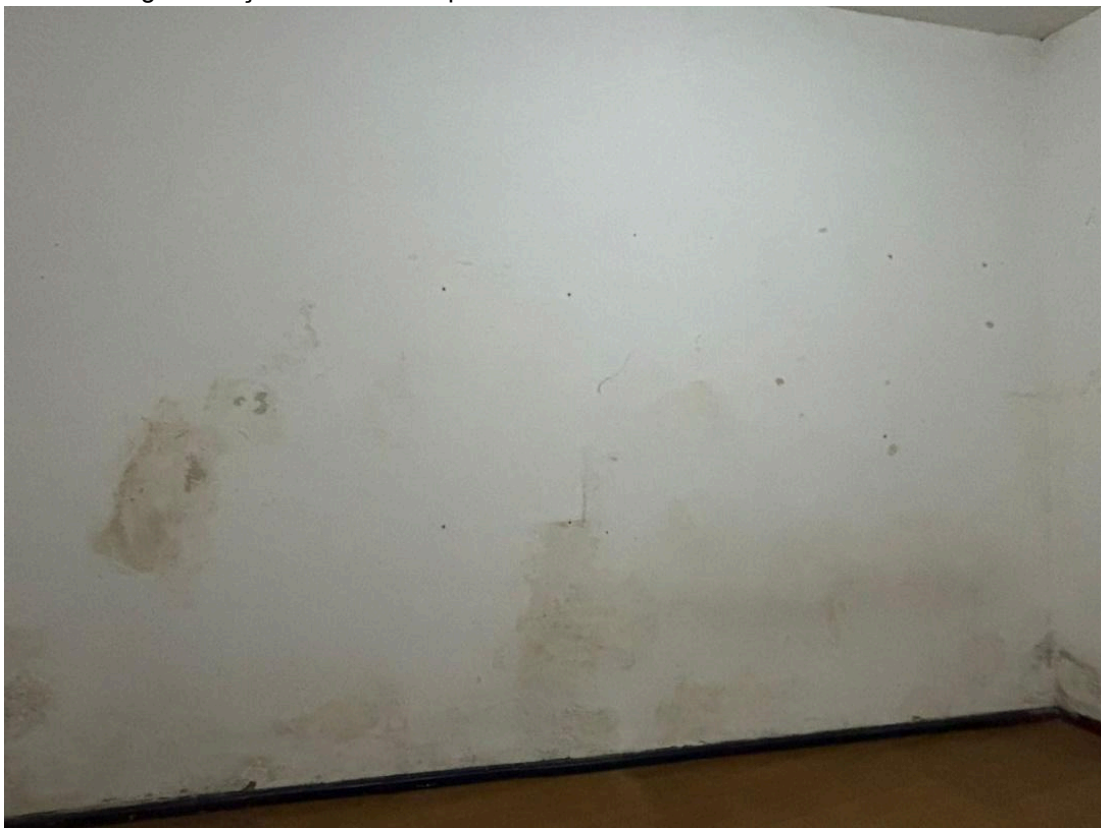
Figura 23: Estágio avançado de mofo na parede.
