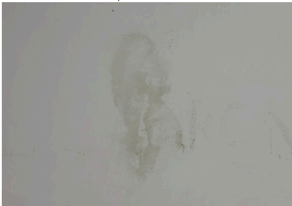
Figura 18: Mancha de mofo localizada na parede.
