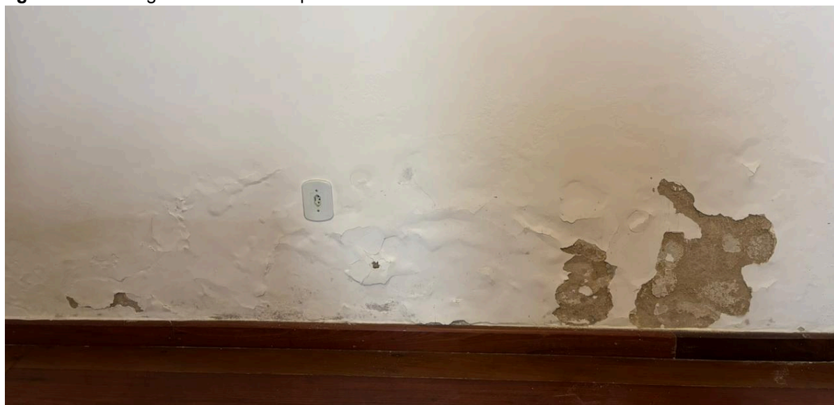
Figura 37: Patologia encontrada na parede da Sala.
