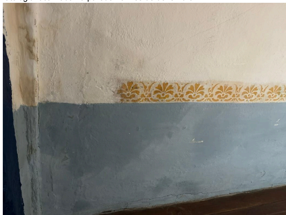
Figura 31: Patologia localizada na parede no mês de dezembro.
