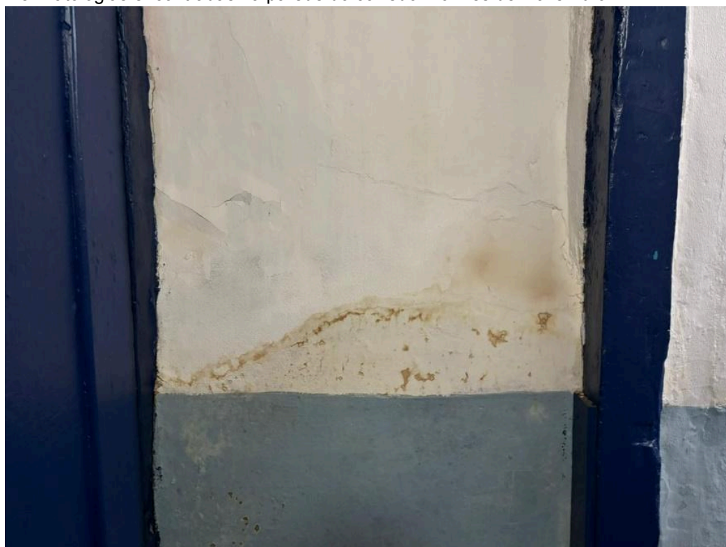
Figura 28: Patologias encontradas na parede do corredor no mês de Novembro.
