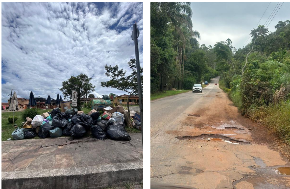
Figura 33 - Descarte irregular de resíduos e danos estruturais no leito carroçável
