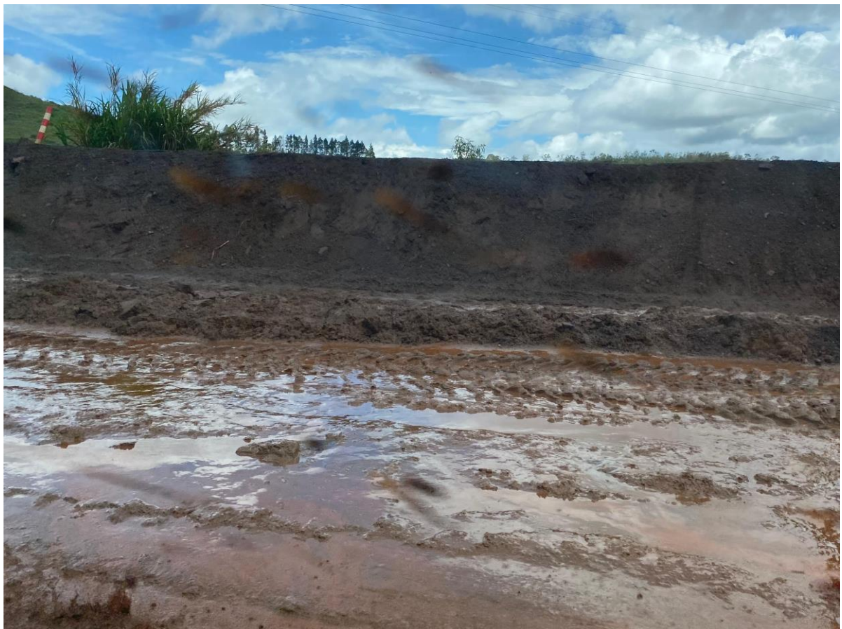
Figura 5 - Degradação da via operacional e formação de lamaçal sob saturação hídrica
