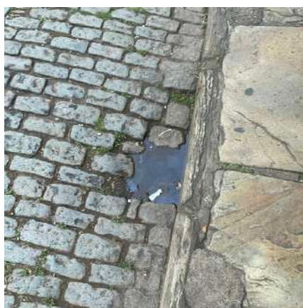
Figura 59: Acúmulo de água na pista do Largo de Coimbra
