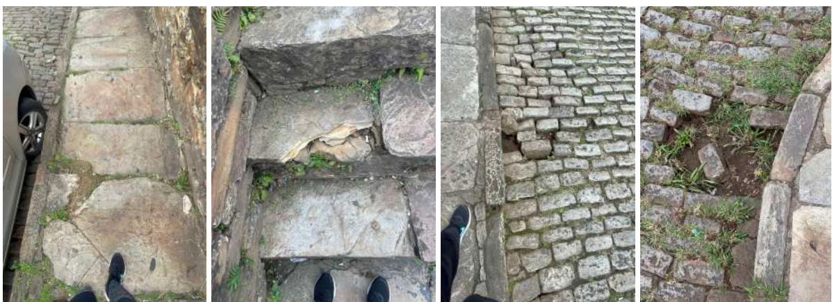
Figuras 42, 43, 44 e 45: Danos na pavimentação do Largo de Coimbra
