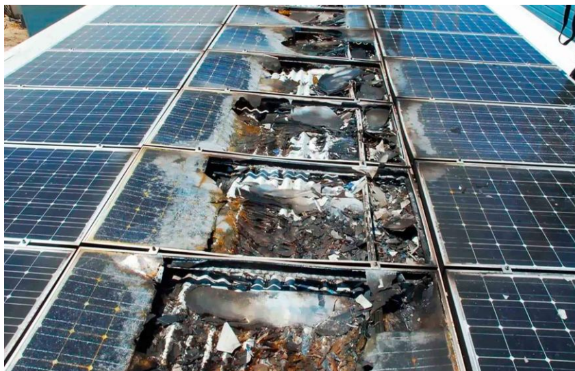
Figura 2- Módulos fotovoltaicos danificados devido ao hotspot .
