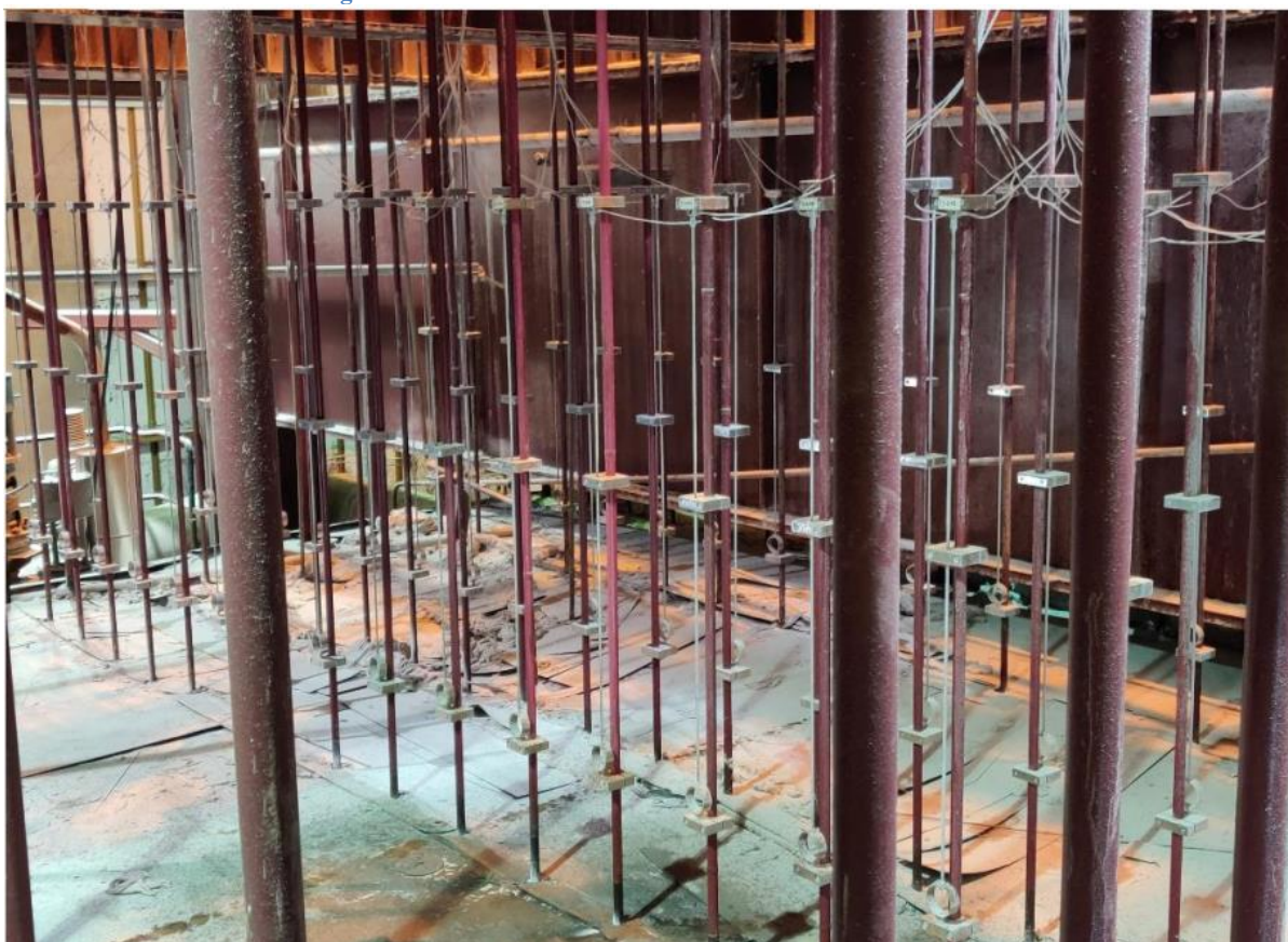
Figura 13 - Sensores do sistema HEWI na fábrica de Varkaus
