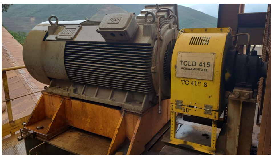
Figura 4 – Motor elétrico de indução trifásico instalado em campo. Fonte: Elaboração própria.
