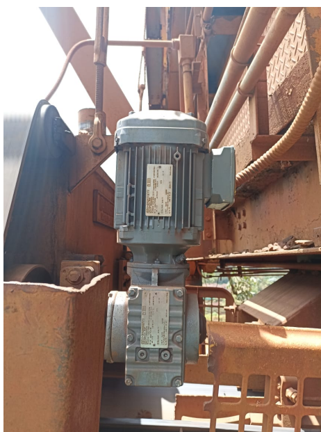
Figura 6 – Motorreductor instalado em campo. Fonte: Elaboração própria.
