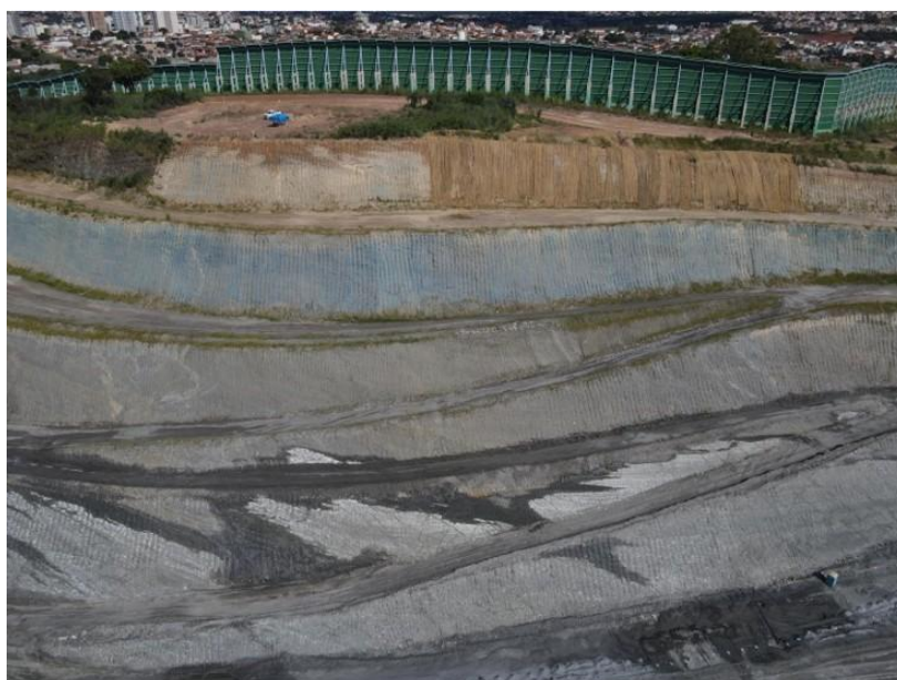
Figura 18 - Rampas de drenagem já implementadas e operantes. Fonte: AZEVEDO et al. , 2024.
