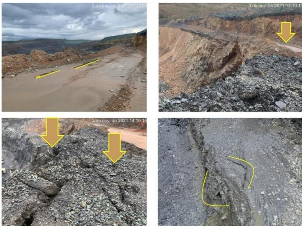
Figura 1 - Presença de erosão nas bermas da mina. Fonte: AZEVEDO et al. , 2024.
