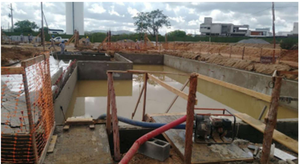
Figura 2 - Acúmulo de água em piscina não finalizada (FARIAS, 2022).
