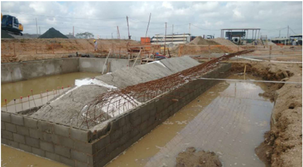
Figura 1 - Alagamento anterior à concretagem de laje (FARIAS, 2022).
