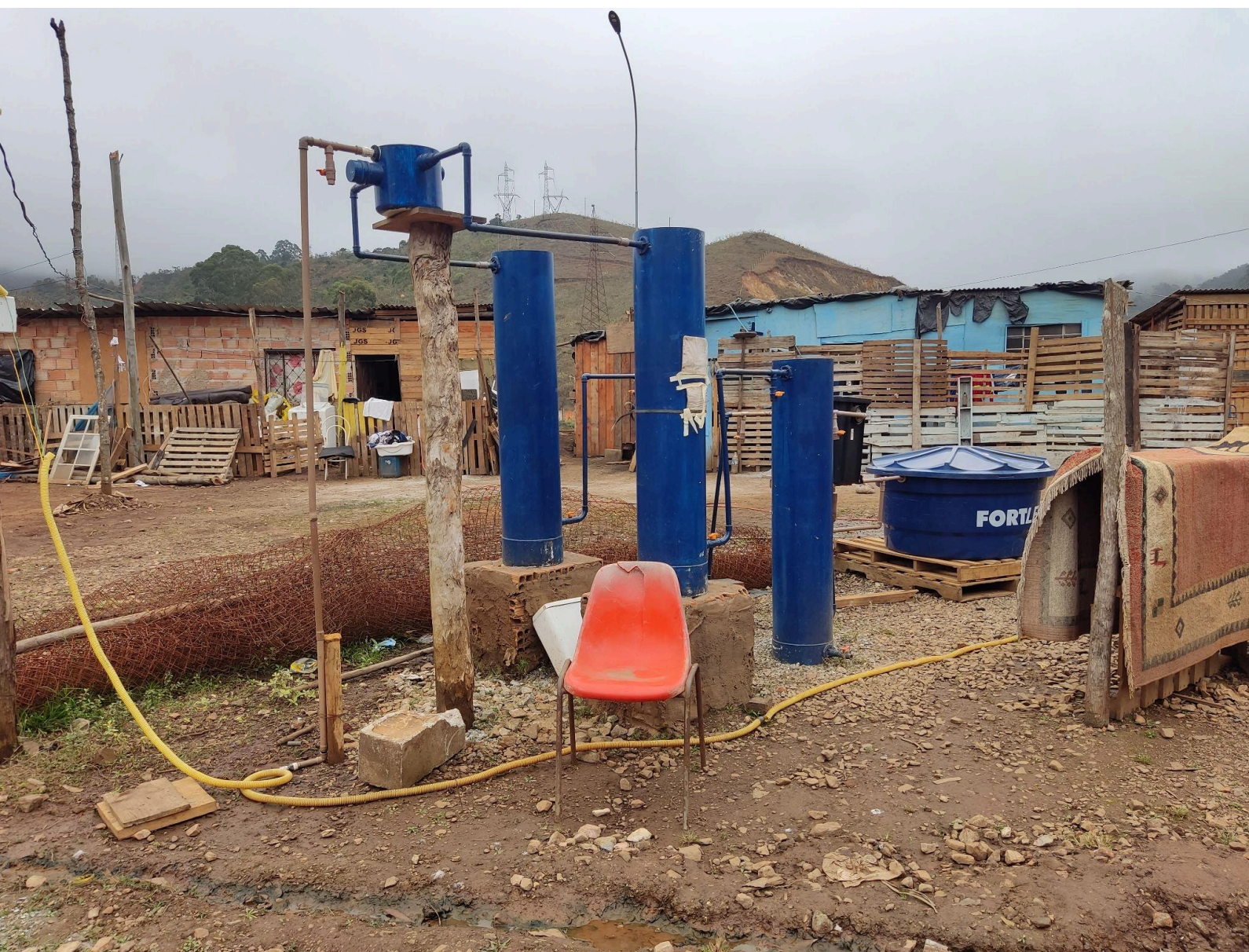
Figura 13: Estação de captação e tratamento de água, Ocupação Chico Rei II
