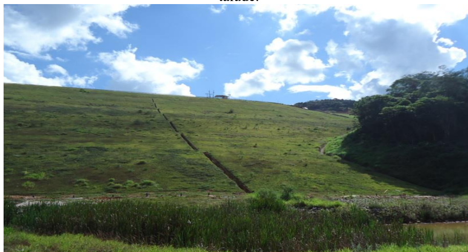
Figura 9 – Combinação de proteção superficial com gramíneas e condutores de águas pluviais em um talude.
