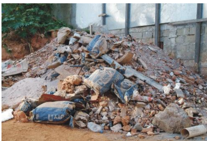
Figuras 06 e 07: Resíduos de construção civil.
