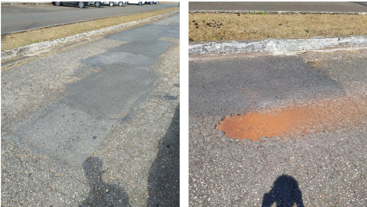
Figura 36 - Remendos e panela no trecho entre estação 16 e estação 20. Fonte: Acervo próprio.
