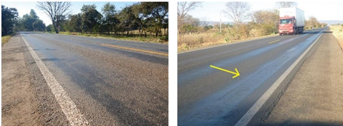
Figura 12 - Exsudação na superfície de pavimento. Fonte: CNT (2017).
