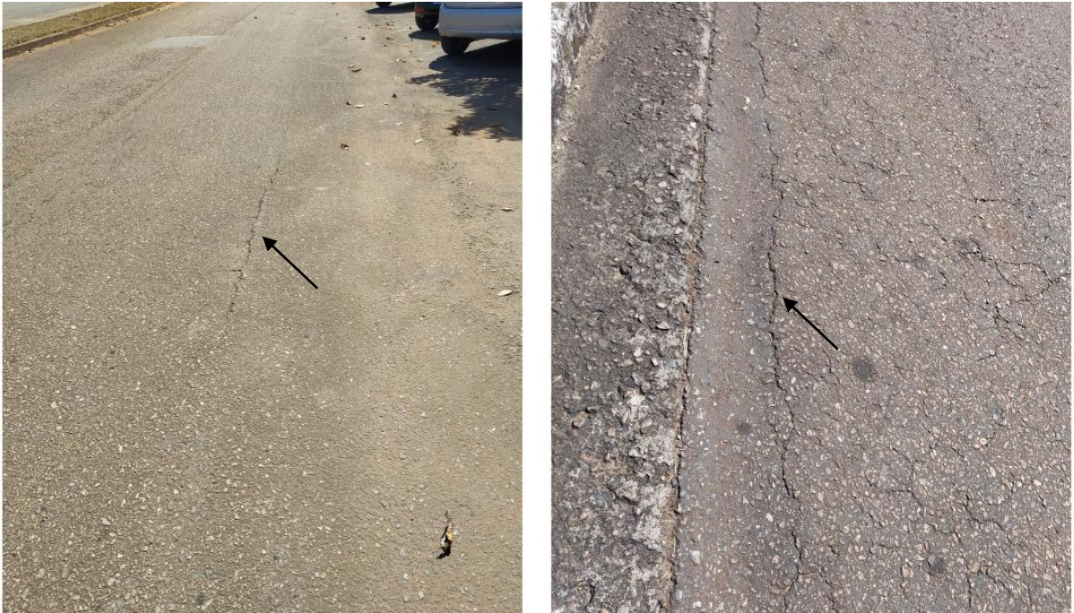
Figura 4 - Trincas longitudinais no pavimento do campus Morro do Cruzeiro. Fonte: Acervo próprio.
