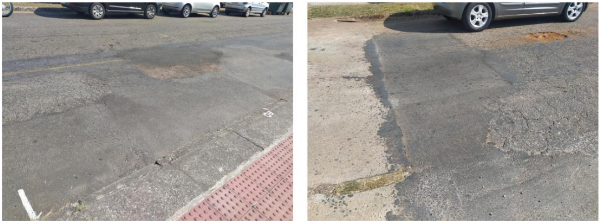
Figura 35 - Remendos e panela no trecho entre estação 0 e estação 2. Fonte: Acervo próprio.
