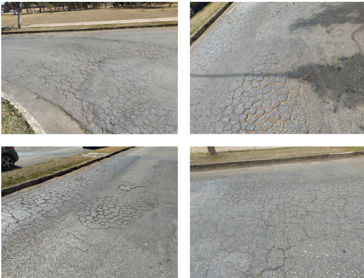
Figura 34 - Trincas “couro de jacaré” no pavimento do Campus. Fonte: Acervo próprio.
