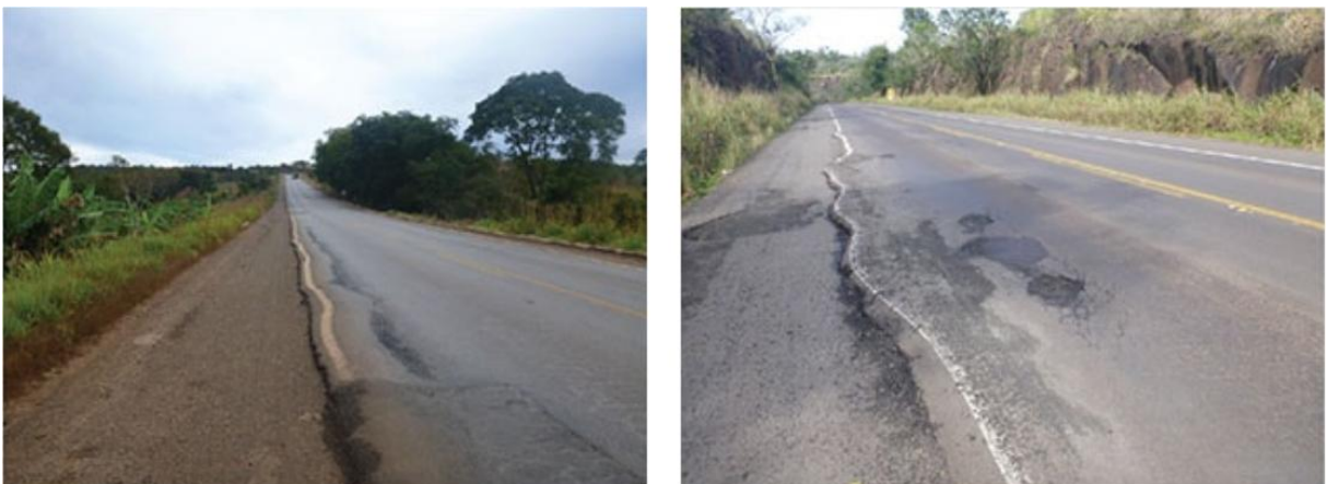
Figura 11 - Escorregamento do revestimento asfáltico. Fonte: CNT (2017).
