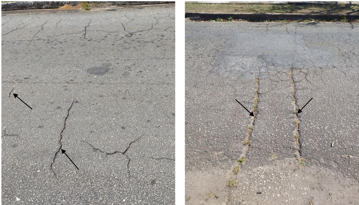
Figura 3 - Trincas transversais no pavimento do campus Morro do Cruzeiro. Fonte: Acervo próprio.
