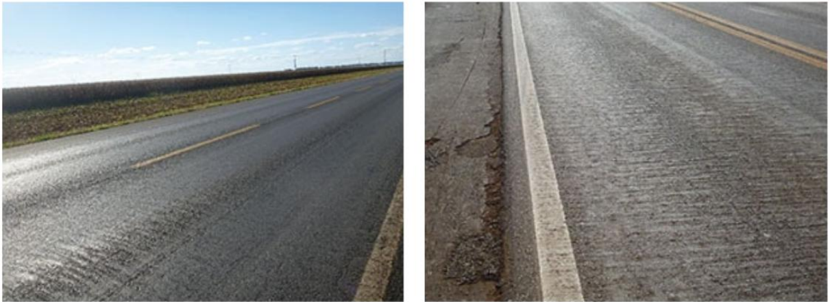
Figura 10 - Ondulação ou corrugação. Fonte: CNT (2017).
