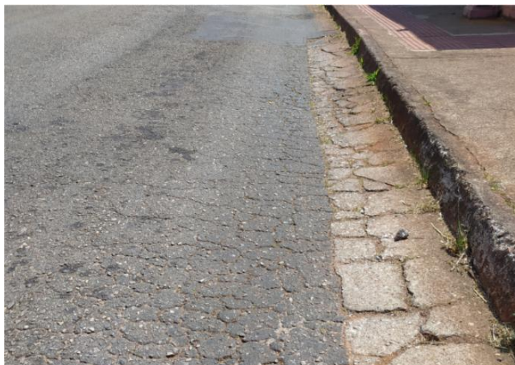
Figura 9 - Afundamento de consolidação da trilha de roda somado a trincas “couro de jacaré” no pavimento do campus Morro do Cruzeiro. Fonte: Acervo próprio.
