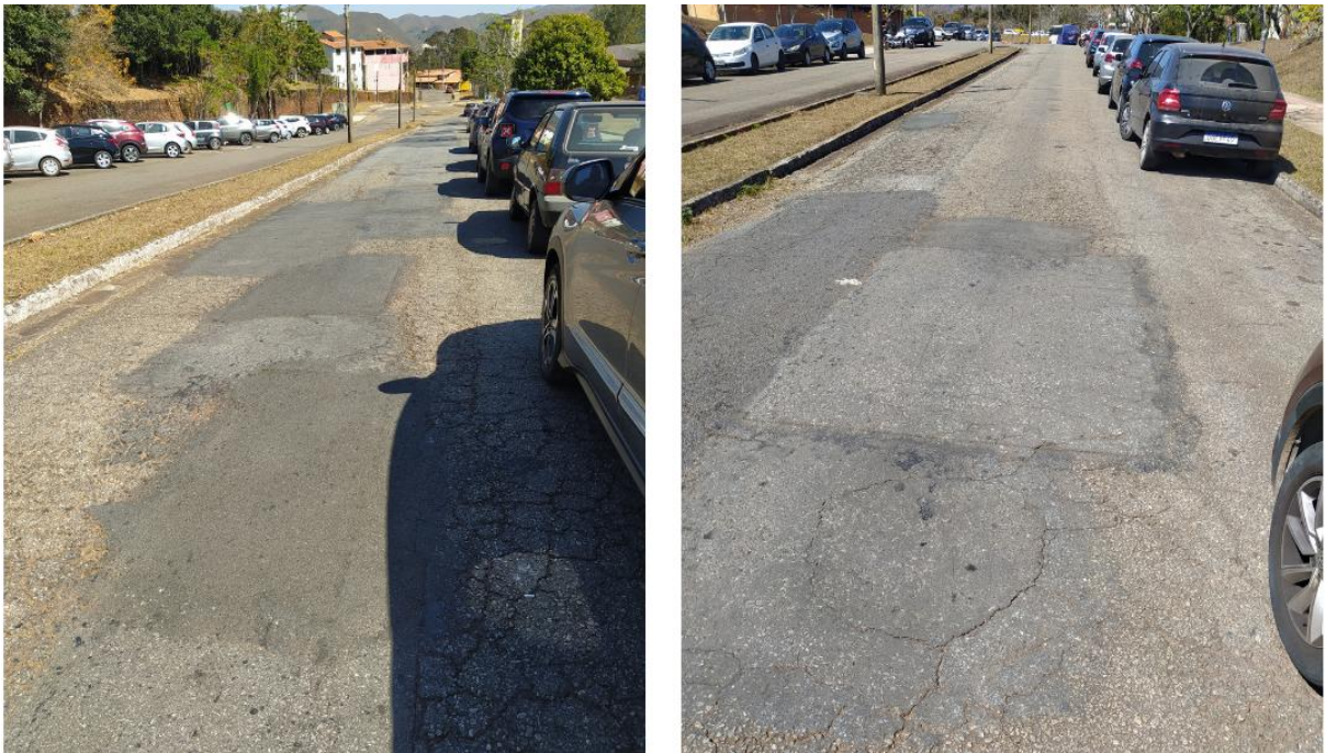
Figura 15 - Remendos no pavimento do campus Morro do Cruzeiro. Fonte: Acervo próprio.
