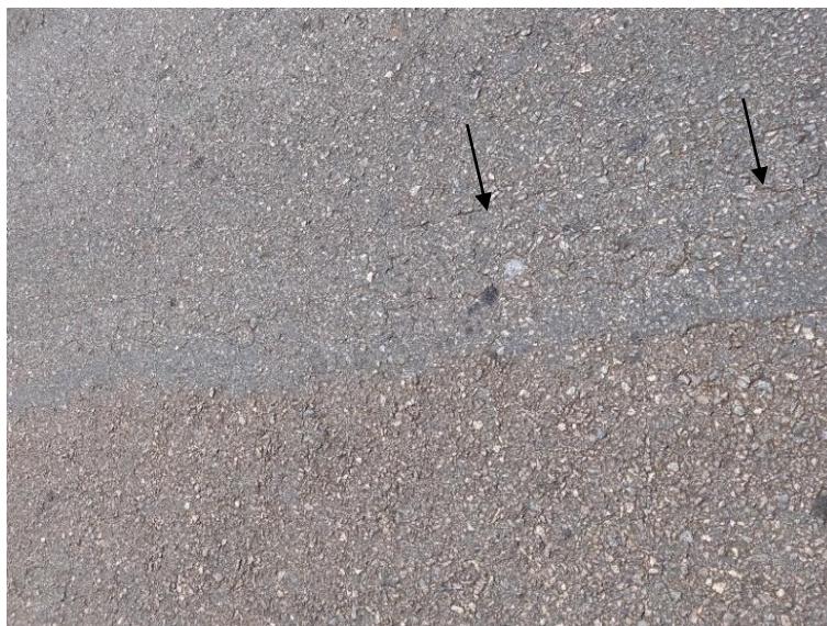
Figura 2 - Fissuras no pavimento do campus Morro do Cruzeiro. Fonte: Acervo próprio.
