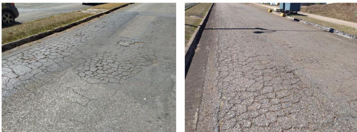
Figura 6 - Trincas do tipo “couro de jacaré” no pavimento do campus Morro do Cruzeiro. Fonte: Acervo próprio.
