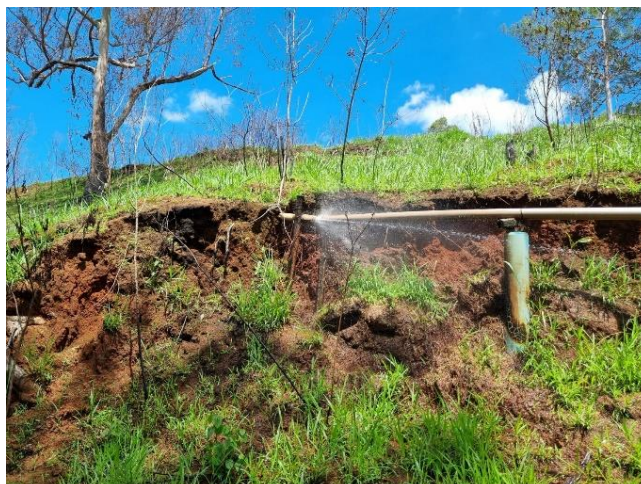
Figura 31 - Vazamento de tubulação localizada próxima ao ponto 2. Fonte: O autor, 2023
