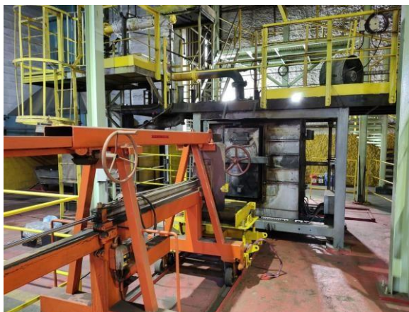
Figura 4.4. Forno Piloto da Gerdau Ouro Branco.
