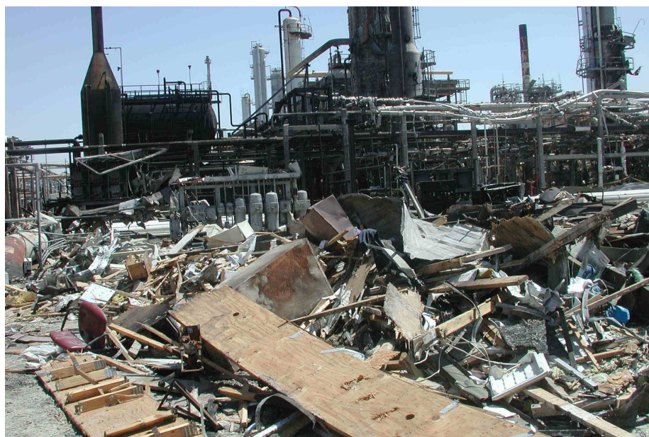
Figura 4 – Acidente ocorrido na BP Texas Refinery, em 2005. Fonte: Board (2007) .
