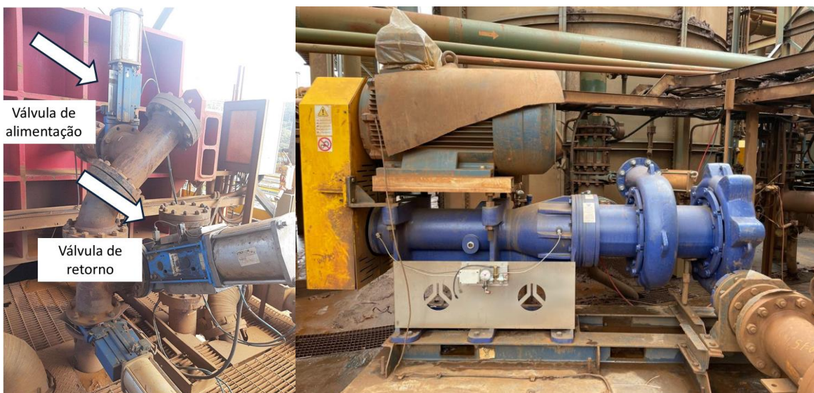
Figura 9: Cabeça Fixa, Válvula de Alimentação, Válvula de Retorno e Bomba de Duplo Estágio.
