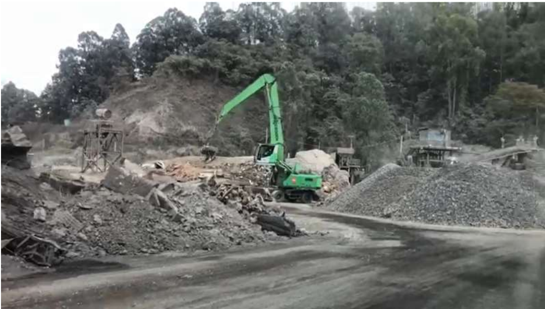
Figura 9 - Equipamento eletromagnético em atuação no pátio de sucatas em João Monlevade
