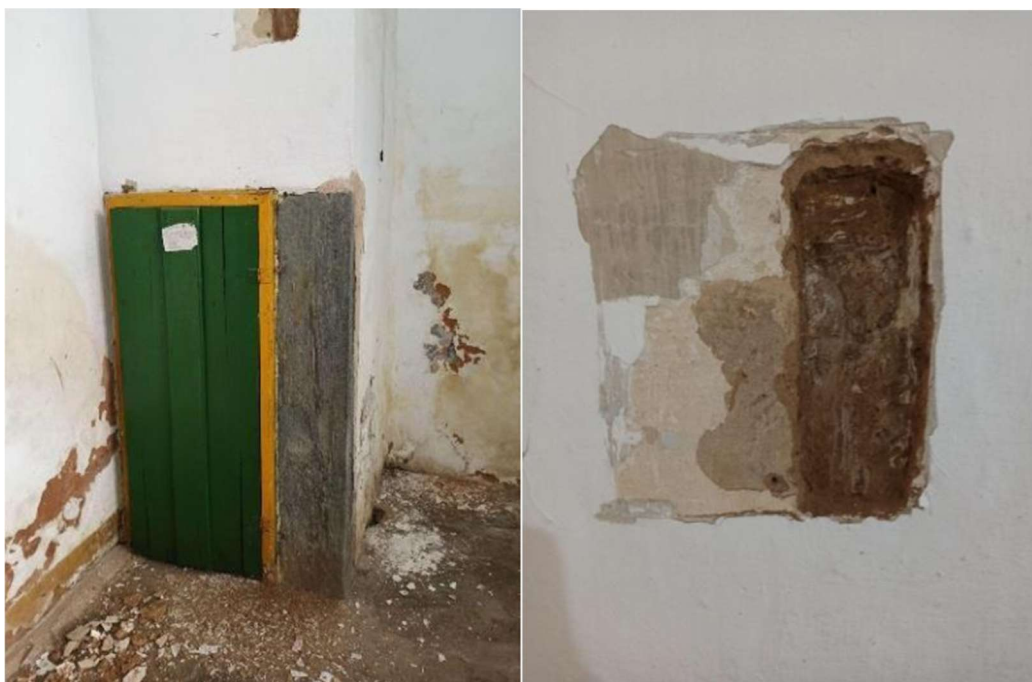
Figura 34 - As imagens ilustram o bloco onde está localizada a esquadria P06 e a prospecção que acusa o método construtivo original.
