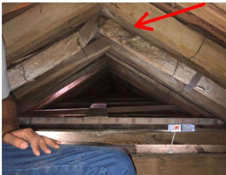
Figura 55 – Visão transversal do telhado, é possível observar a deterioração de algumas tesouras.
