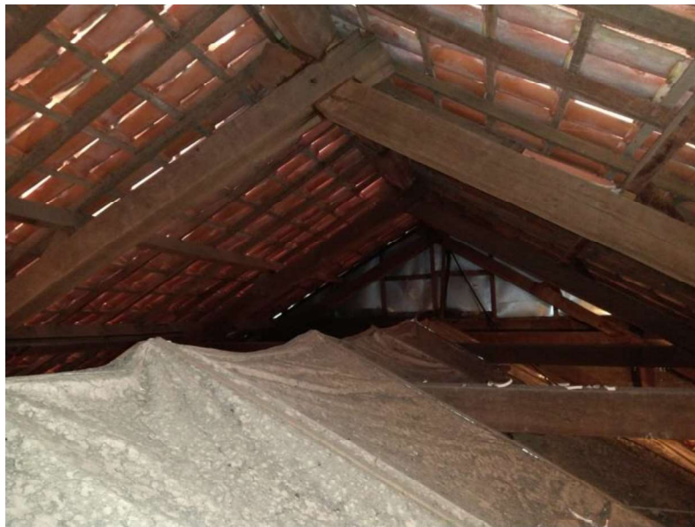
Figura 39 – Intercessão das pernas da tesoura com a cumeeira, onde é possível observar o transpasses entre as pernas, criando apoio para a cumeeira.
