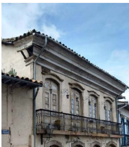
Figura 14 – Cimalha em madeira com a estrutura de mão francesa exposta. Rua Getúlio Vargas, Ouro Preto.
