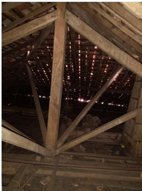
Figura 48 – Visão da estrutura do telhado, destacando o pendural do ponto mais alto do telhado.
