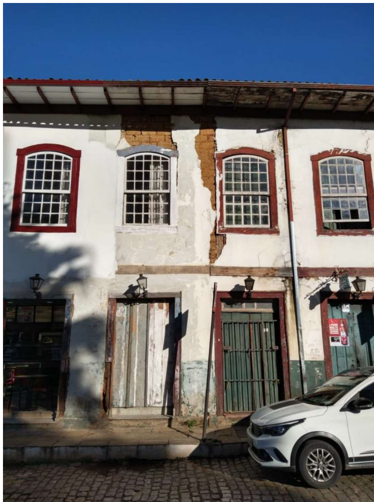
Figura 5 – Queda de revestimento expõe construção em adobe. Rua Dom Viçoso, Mariana.
