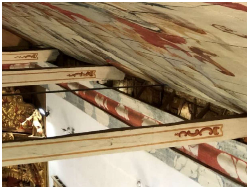
Figura 57 – Visão do forro e acima da cimalha, observa-se a presença de hastes metálicas para impedir a movimentação das tesouras, porém em quantidades insuficientes.
