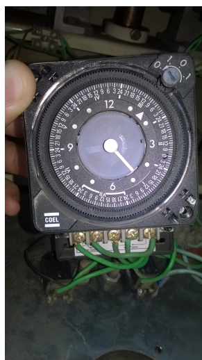
Figura 12 – Interruptor Horário COEL danificado
