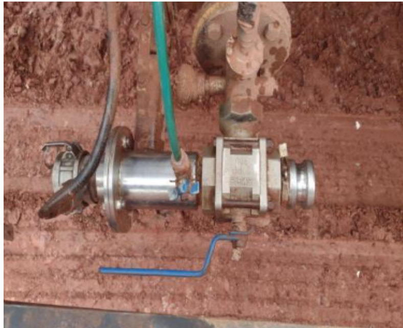
Figura 14 - Válvula de bloqueio da sucção e passagem do produto através do misturador estático
