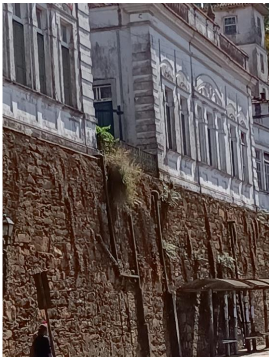
Figura 57 – Canos de esgoto visíveis na fachada lateral em direção ao Alto da Cruz
