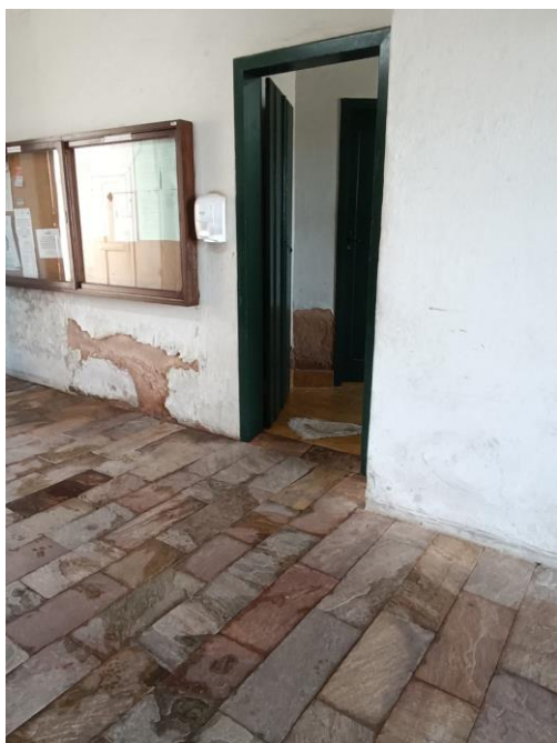
Figura 60 – Paredes que precisam de reparação
