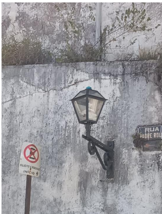
Figura 55 – Hera em fachada lateral (Rua Padre Rolim)
