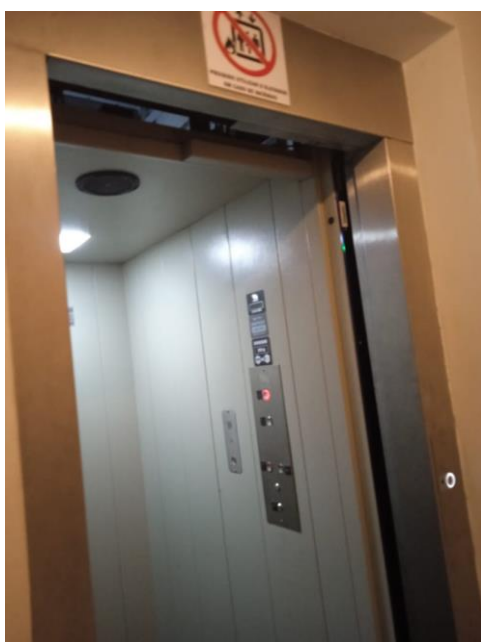
Figura 11 – Elevador para pessoas com deficiências motoras – Museu da Inconfidência, Ouro Preto (MG)
