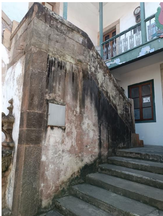
Figura 64 – Escadaria com líquens, sujeira e umidade
