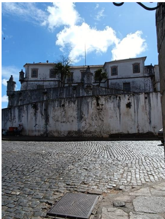
Figura 54 – Visão da degradação por umidade do prédio a partir da Praça Tiradentes
