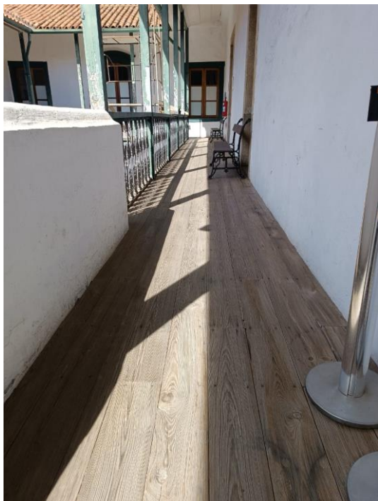
Figura 59 – Madeira degradada de piso que leva a várias repartições importantes do prédio
