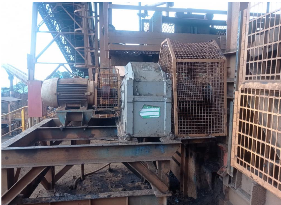
Figura 14 – Conjunto de acionamento do transportador. Fonte: Pesquisa direta (2023)
