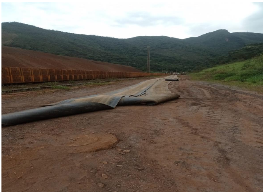
Figura 16 – Resíduos gerados pela substituição da correia. Fonte: Pesquisa direta (2023)
