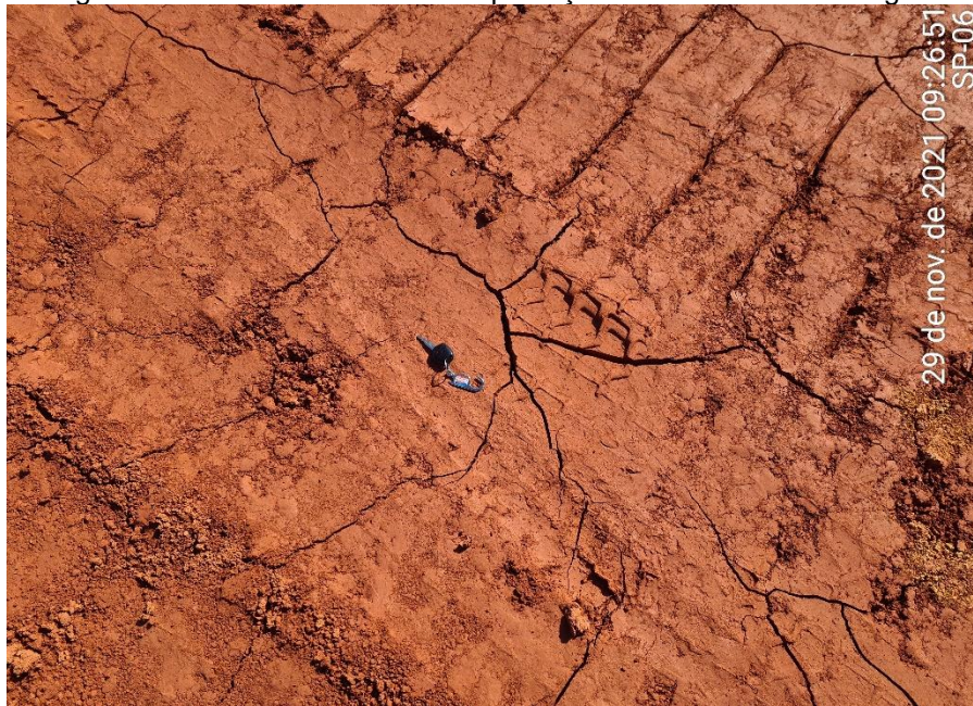
Figura 25 – Reservatório 02 - compactação sem controle tecnológico
