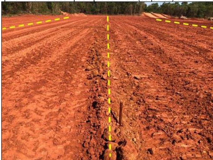
Figura 12 – Comparativo entre a compactação com rolo (esquerda) e com trator esteira (direita)
