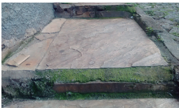
Figura 18: Bolor evidenciando o aparecimento de patologias.
