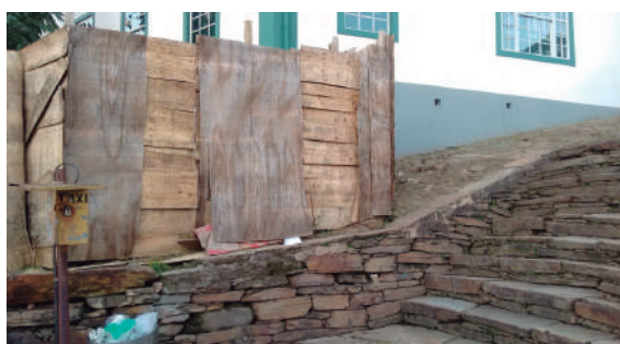
Figura 7: Ausência de corrimão.
