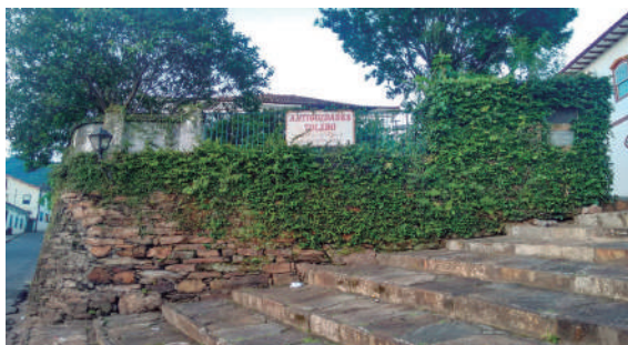
Figura 7: Ausência de corrimão e vegetação excessiva no muro adjacente.
