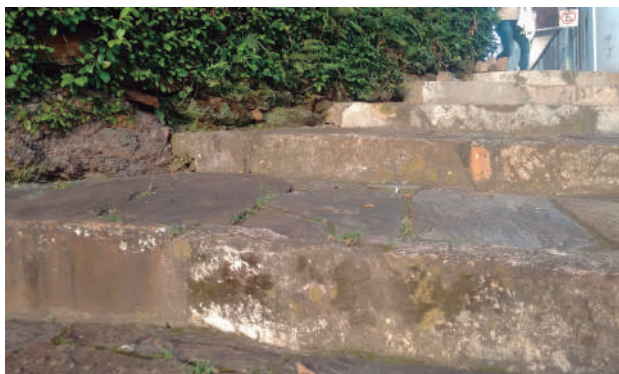
Figura 17: Presença de bolor principalmente nos espelhos dos degraus.
