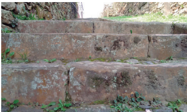
Figura 16: Bolor evidenciando o aparecimento de patologias.
