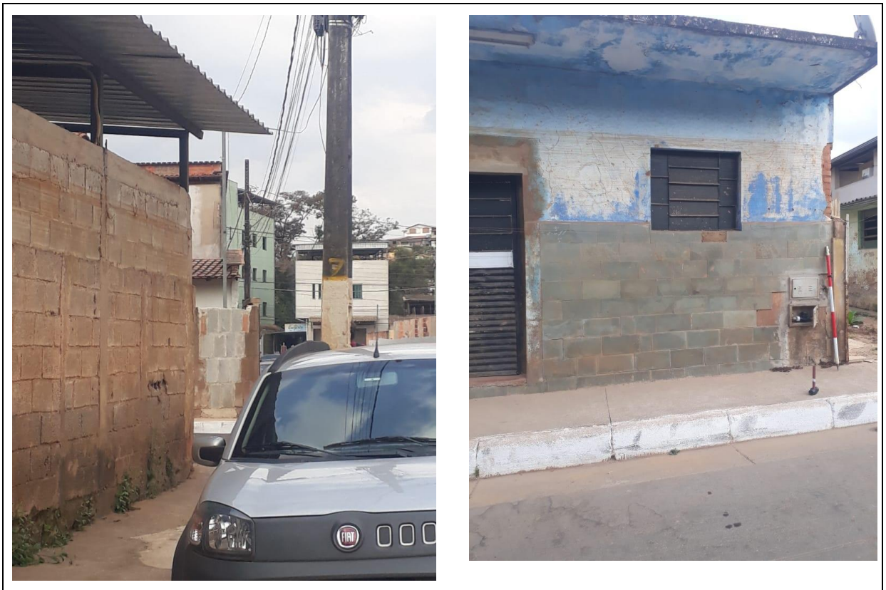
Figura 10 – Marcas da Cheia, do dia 08/01/2022, na Rua Lígia.
