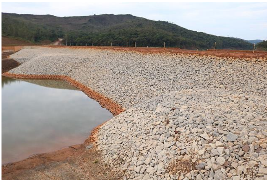
Figura 17: Uso de rocha estéril como muro de contenção do talude de barragem de rejeito.
