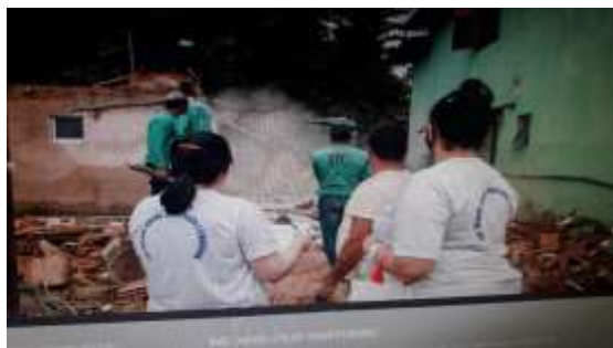
Figura 3 – atuação da Defesa Civil frente aos estragos causados pela chuva
