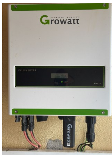
Figura 27: Inversor Growatt. Fonte: Pesquisa Direta (2023).
