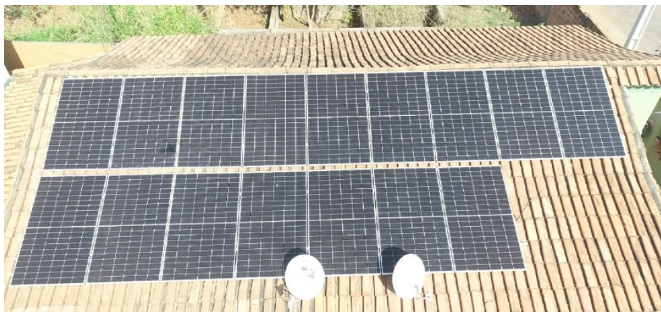
Figura 29: Usina fotovoltaica em Paraopeba/MG. Fonte: Pesquisa Direta (2021).
