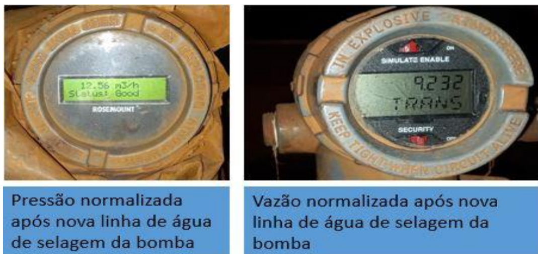
Figura 30 – Regularização da vazão e pressão de trabalho. Fonte: Pesquisa direta (2022).
