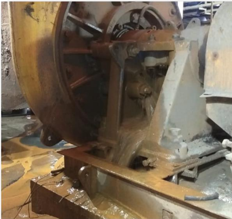
Figura 11 – Situação da bomba antes da parada. Fonte: Pesquisa direta (2022).
