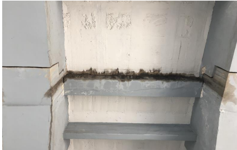
Figura 19: Dente Gerber e junta de dilatação do viaduto, imagem de autoria própria
