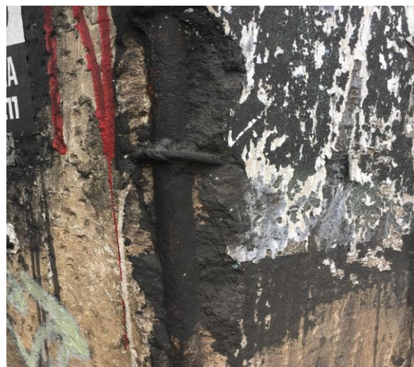
Figura 17: Imagem de armadura exposta e em processo de corrosão, imagem de autoria própria.
