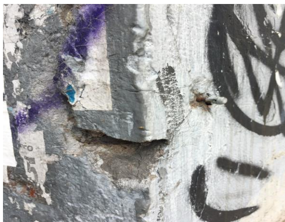
Figura 15: Imagem de deslocamento do concreto por corrosão das armaduras, imagem de autoria própria.
