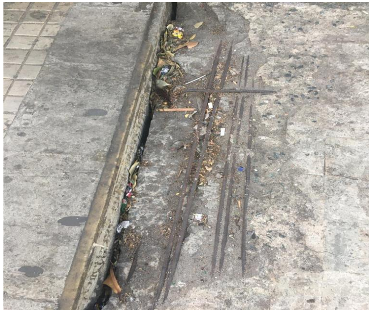
Figura 14: Armadura exposta e em processo de corrosão, imagem de autoria própria
