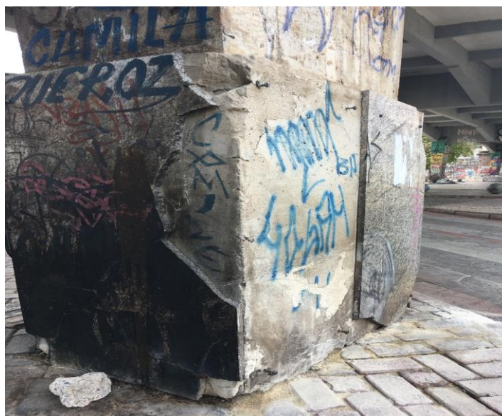
Figura 10: Descolamento de camada de proteção do pilar, imagem de autoria própria.
