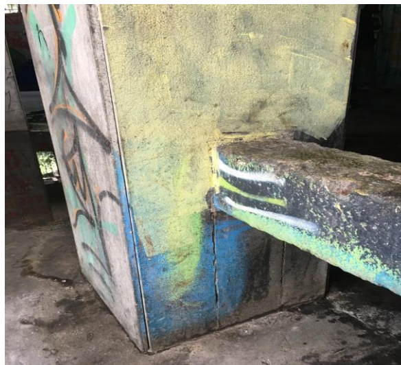
Figura 8: Rachadura em camada de proteção do pilar, imagem de autoria própria
