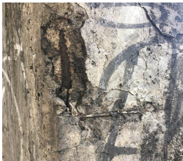
Figura 16: Armadura exposta e em processo de corrosão, imagem de autoria própria.
