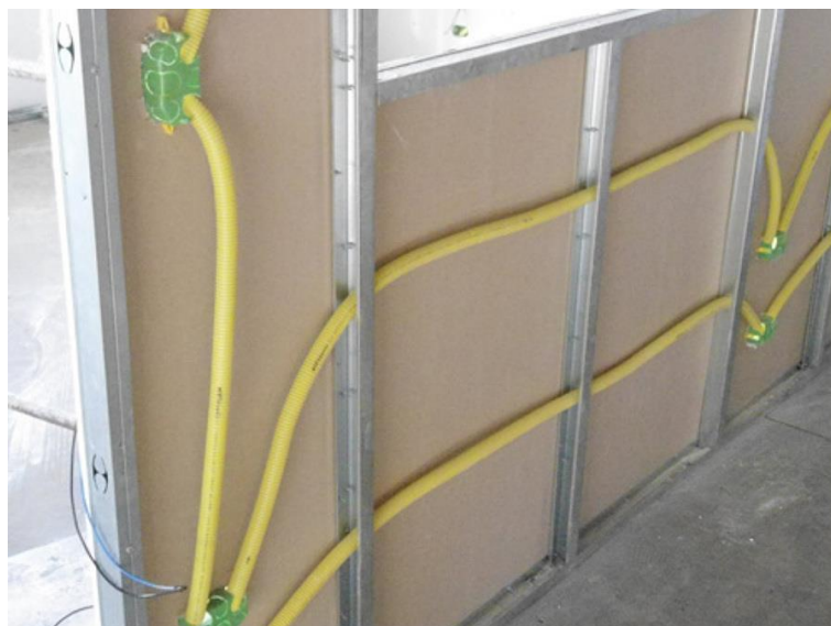
Figura 8 – Sistema de conduítes flexíveis passando por espaços vazados nos montantes. Fonte: Habitissimo (2021).
