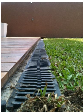
Figura 13 – Canaletas de drenagem.
