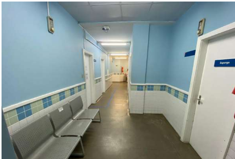
Figura 24: Sala com lanternim impedido pelo rebaixo de gesso da UBS Jardim Camburi.
