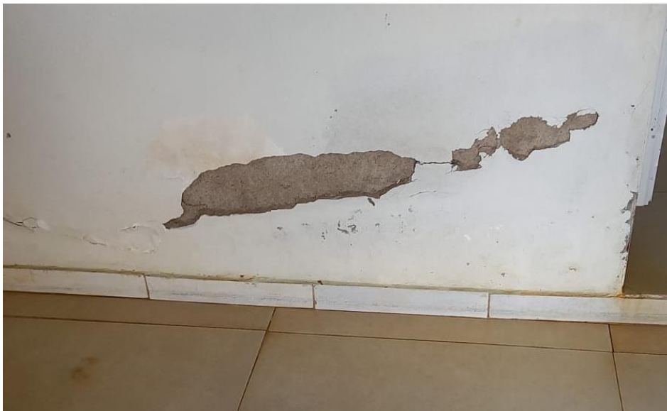
FIGURA 5 – Parede do vestiário feminino com infiltração. Fonte: Própria Autora.
