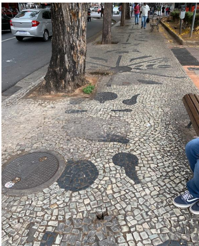
Figura 5-9 – Condições da calçada – Trecho 2.
