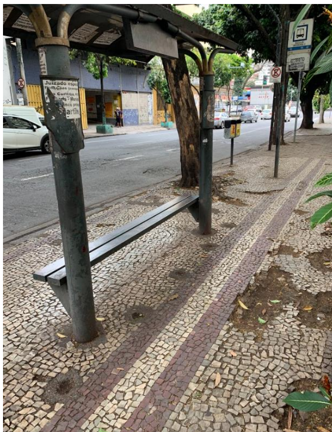
Figura 5-17 – Má qualidade do pavimento e da calçada – Trecho 5F.
